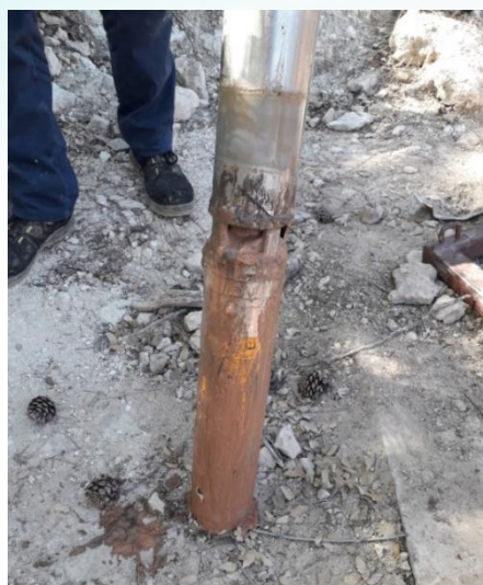
Figura 3 Estat de la bomba una any després de fer el pou. Durant tot aquest temps, el pou no ha entrat en funcionament.
