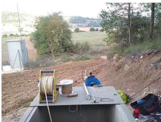
Detall general de l'arqueta on s'ubica la captació. El pou s'ubica al lateral d'un camp de conreu. A la part esquerra de la fotografia es veu part de les instal·lacions fotovoltaïques que haurien d'alimentar la bomba.
