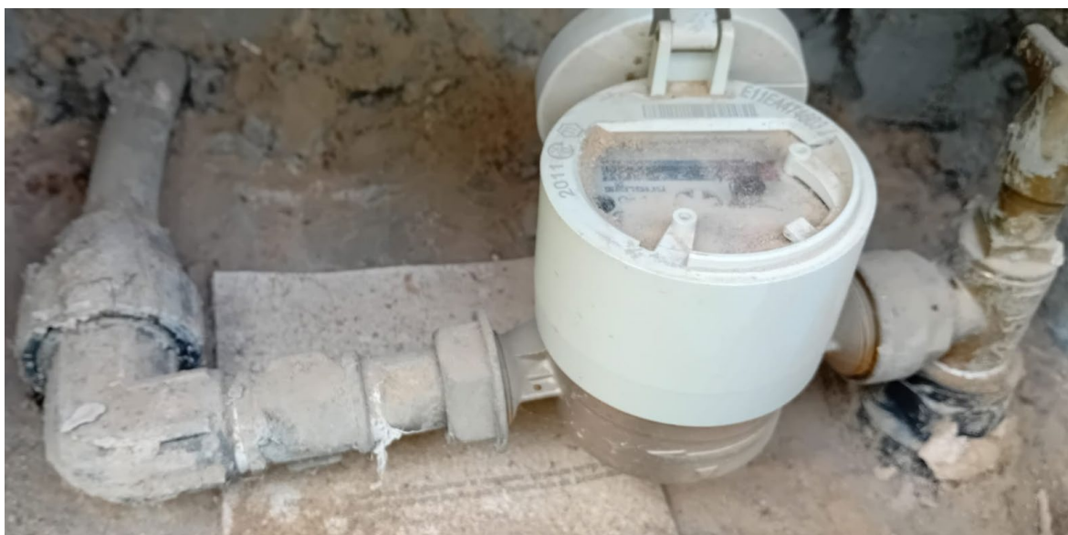
Figura núm.2 Instal·lació amb el comptador existent a La Pobla de Massaluca (Font: pròpia)
