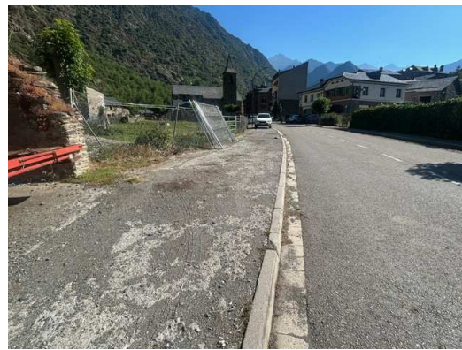
Imatge 02. Estat actual de la vorera i la tanca/barrera limitant.
