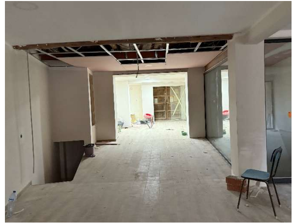
Falta una part del cel ras. Falta pintar el cel ras del rocòdrom. Falta la barana de protecció de les escales.
