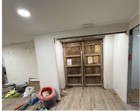
Accés principal. Falta la porta de vidre automàtica.
