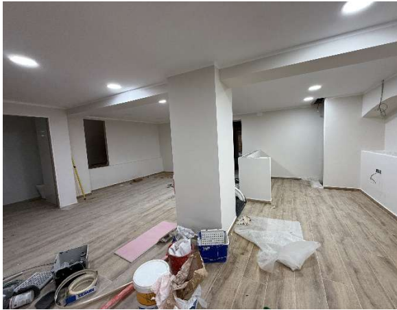
Falta tot el mobiliari de cuina. Zona de forn i zona de bar.
