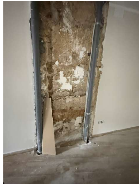
Falten tapar tubs i paret amb extradossat. Falten de col·locar mecanismes elèctrics.
