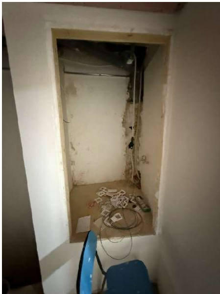
Falta el muntacàrregues.
