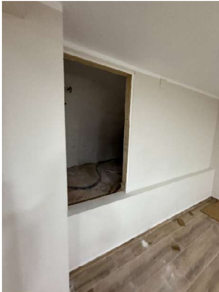
Falta porta armari sotaescales.
