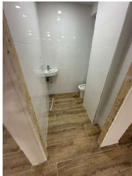
Falta la porta batent del bany 2.
