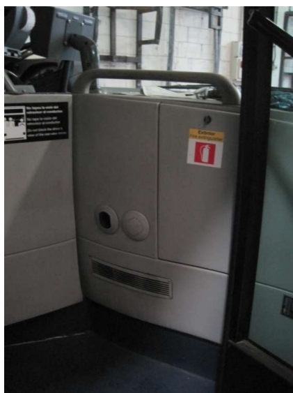
Fig. 3. Ubicació dels Extintors.
