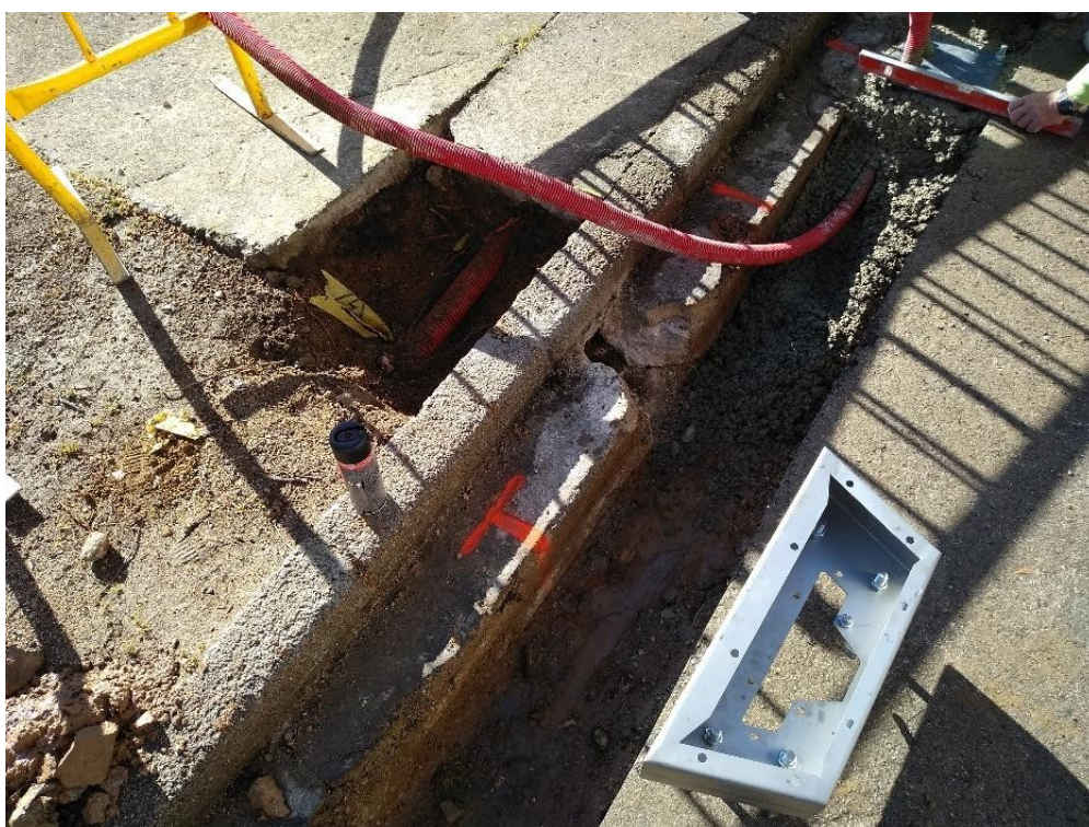
Exemple 7: Imatge d'una instal·lació de Girocleta sobre asfalt on s'aprecia la platina del tòtem
