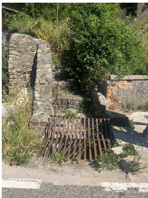
Imatge 03. Estat actual de la reixa que inicia l'obra de drenatge transversal al límit sud de la vorera.
