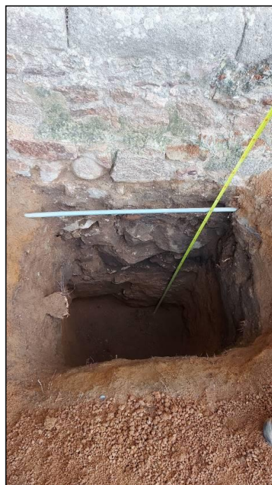
Cala realitzada a la façana de la Plaça del Monestir
