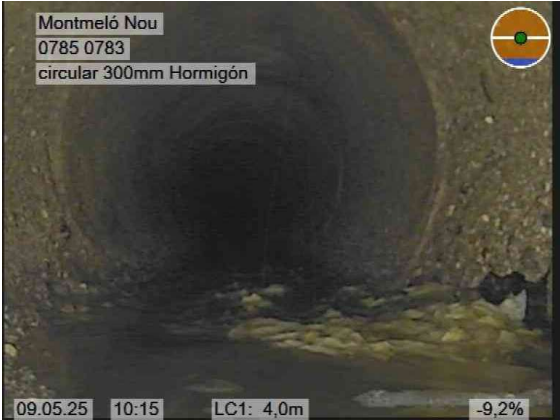
8, 00:01:24, 4.00m Inspeccion abandonada,, Tub trencat
