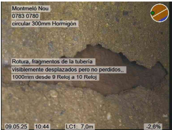
5, 00:01:26, 7.00m Rotura, fragmentos de la tubería visiblemente desplazados pero no perdidos,, 1000mm desde 9 Reloj a 10 Reloj
