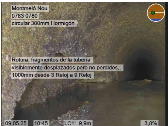
7, 00:02:09, 9.90m Rotura, fragmentos de la tubería visiblemente desplazados pero no perdidos,, 1000mm desde 3 Reloj a 9 Reloj
