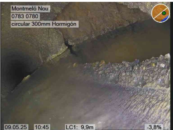
8, 00:02:09, 9.90m Rotura, fragmentos de la tubería visiblemente desplazados pero no perdidos,, 1000mm desde 3 Reloj a 9 Reloj
