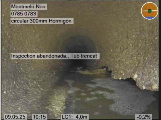
7, 00:01:24, 4.00m Inspeccion abandonada,, Tub trencat
