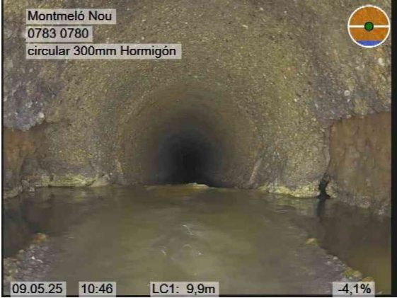
9, 00:02:35, 9.90m Inspecci3n abandonada,, tub esfondrat
