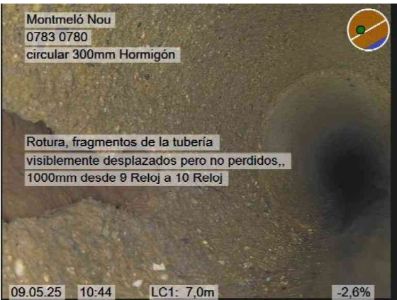
6, 00:01:26, 7.00m Rotura, fragmentos de la tubería visiblemente desplazados pero no perdidos,, 1000mm desde 9 Reloj a 10 Reloj
