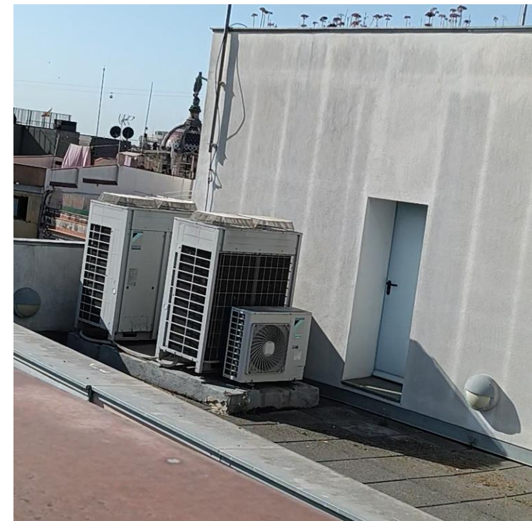
Ubicació coberta i maquinària exterior
