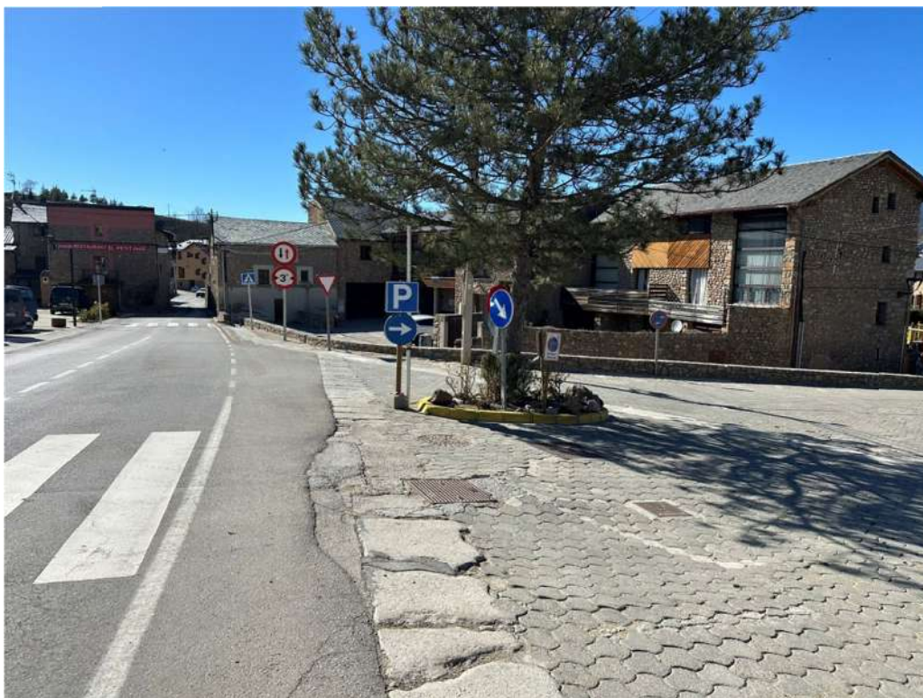
Fotografia 4. Cuneta llindar entre carretera LP-4033b. Deteriorament llamborda central.
