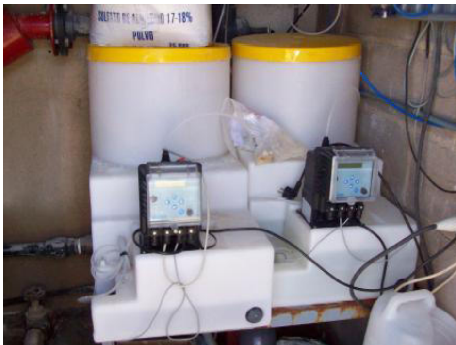
Figura 4. Sistema de cloració dipòsit Coll de Coma (2)
