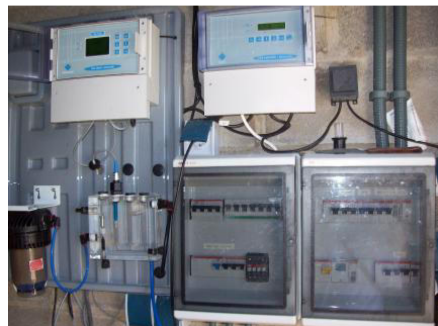
Figura 3. Sistema de cloració del dipòsit Coll de Coma (1)
