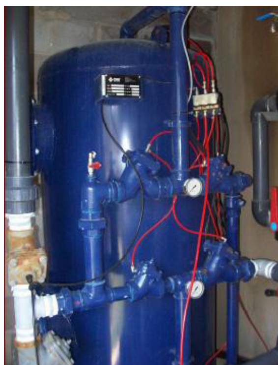
Figura 5. Sistema de filtració dipòsit Coll de Coma
