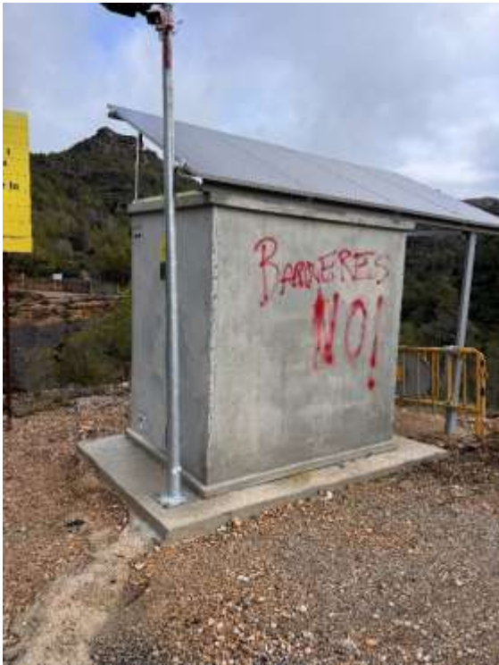
Caseta tècnica de protecció i control d'accés Camí Pantà
