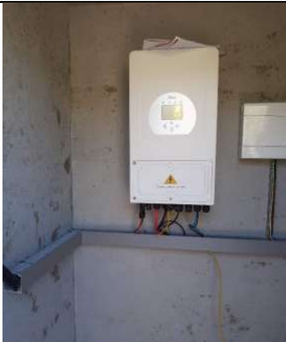
Inversor dins la caseta del camí del pantà
