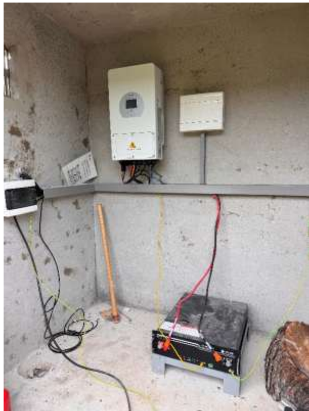
Interior de la caseta: inversor, quadre elèctric i bateria, etc.
