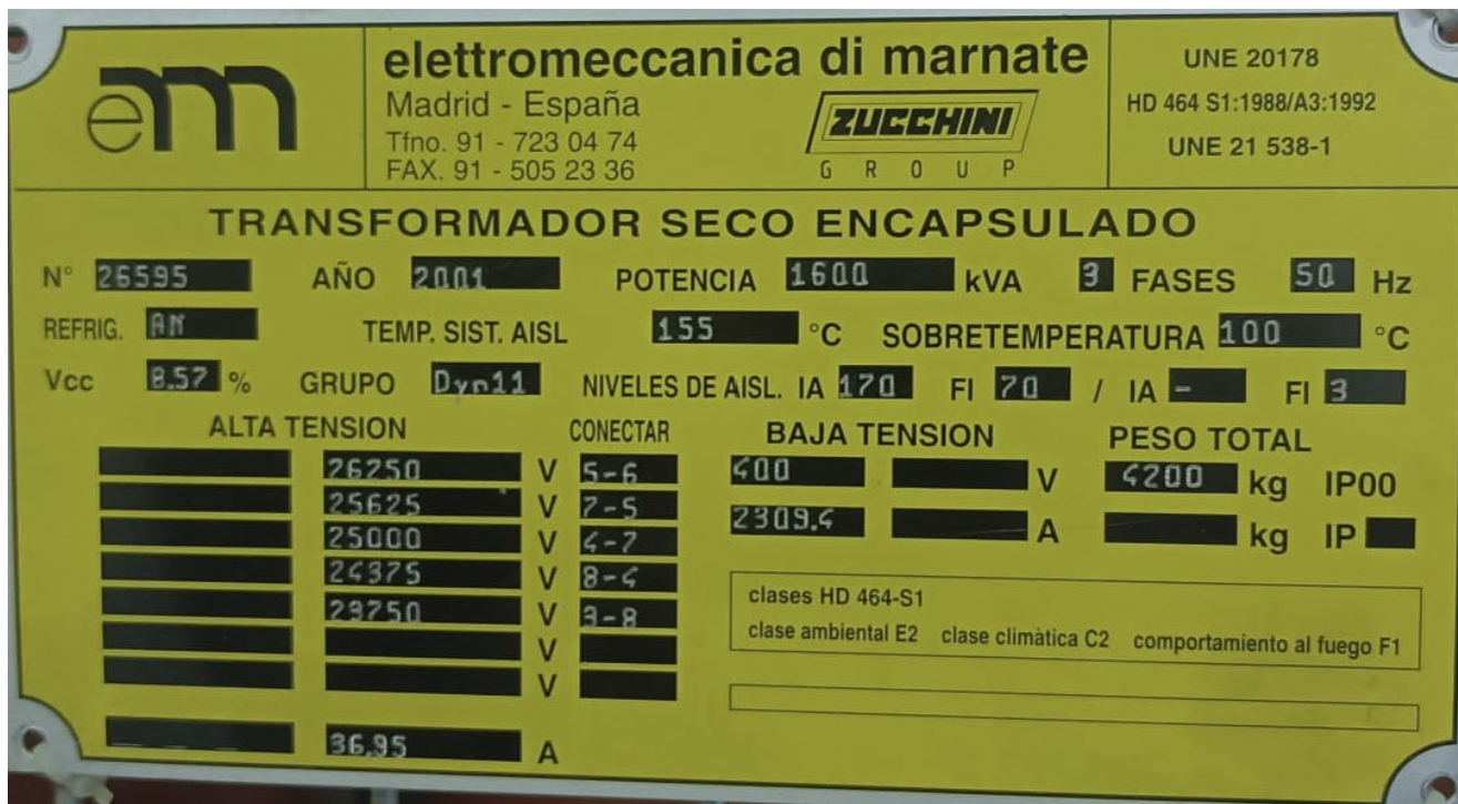
Imatge 7. Placa característiques TR3 (existent, a substituir per nou TR3 de IMEFY)
