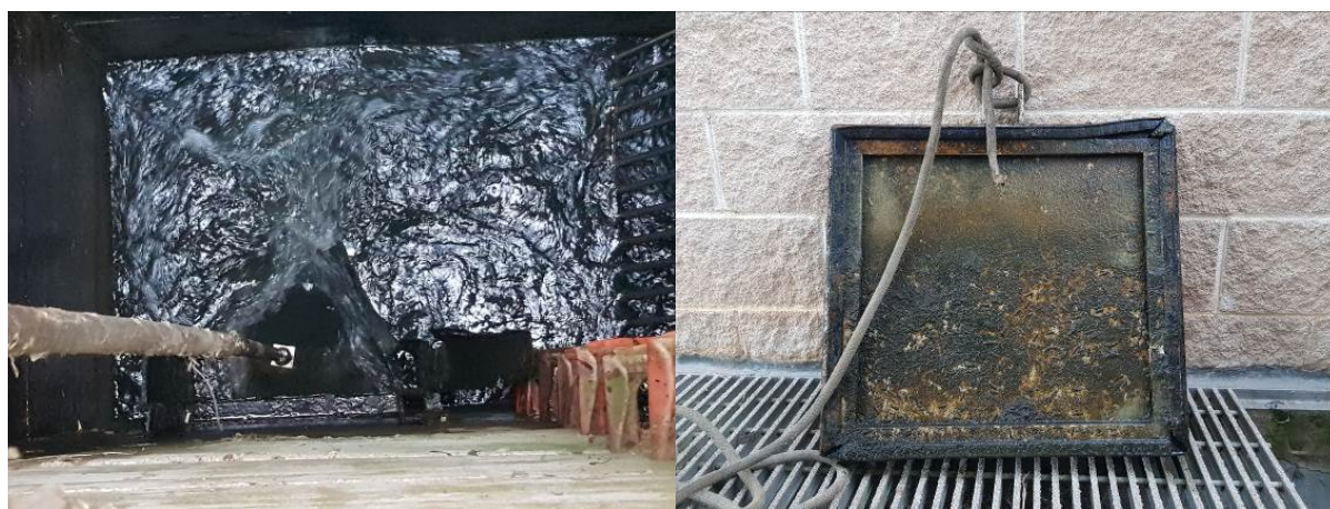
Figura 3. Comporta trencada i entrada descontrolada d'aigua al SAC.
