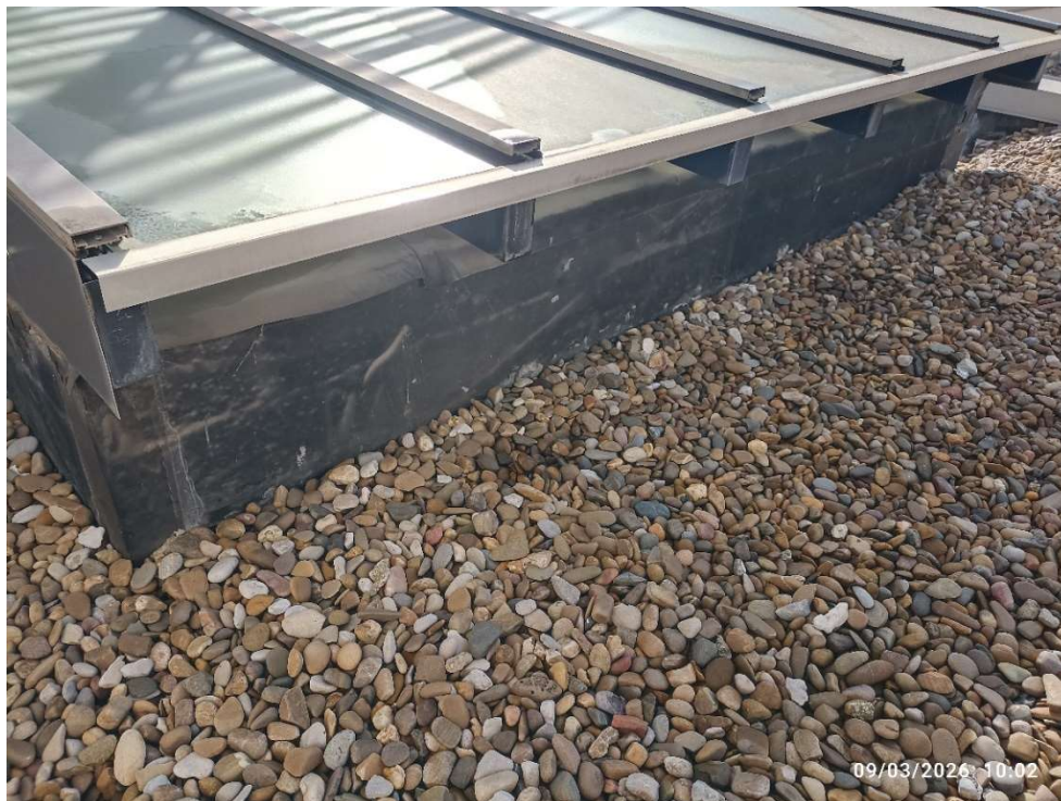
Claraboia a través de la qual es produeix la filtració d'aigua a l'interior de la Biblioteca
