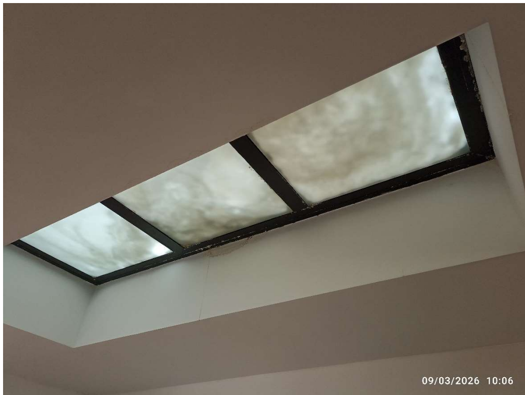
Filtracions en els perímetres de les claraboies de la segona planta
