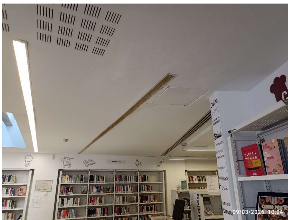
Filtracions d'aigua a través del fals sostre en segona planta que coincideix amb la zona de l'embornals de la coberta on es produeixen les filtracions.
