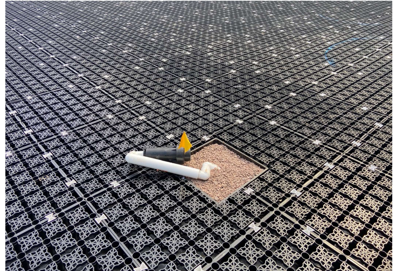
Aspecte de les cel·les drenants amb un aspersor de reg integrat
