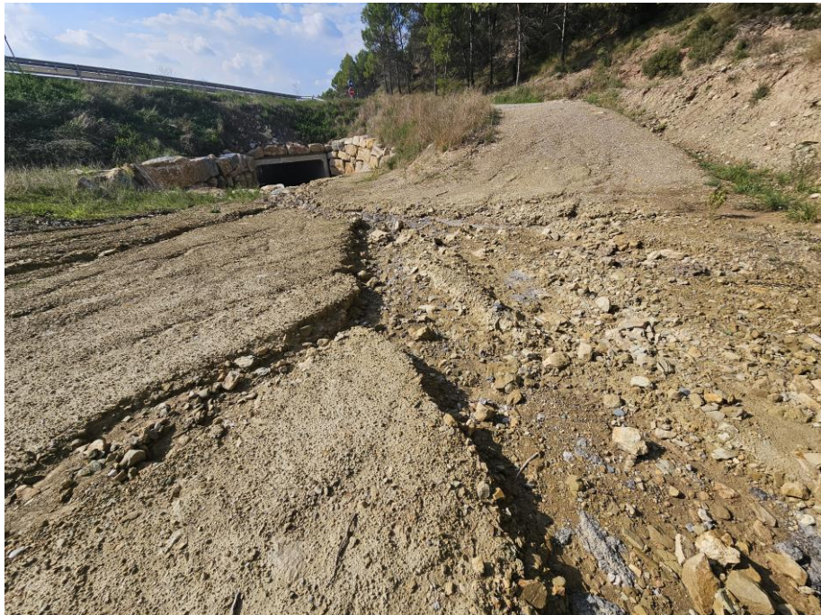
Imatge 12: Xaragalls que s'han format a l'entrada de l'OD 1.6 Font: Imatge pròpia
