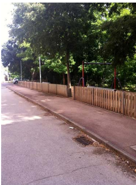
Fotografia 7: Embornal afectat a prop d'un parc infantil. C. Gineta Giubert
