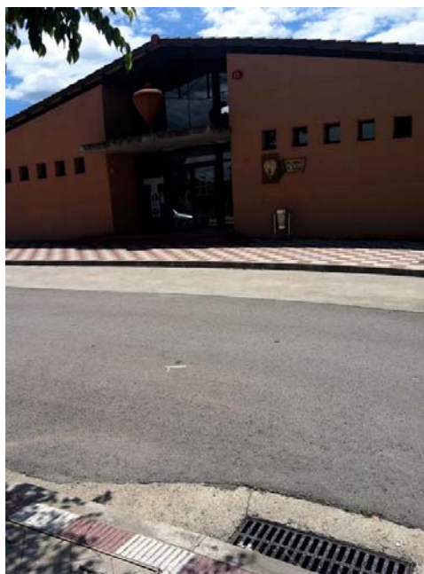
Fotografia 3: Embornal afectat a prop d'un equipament. C. Escoles
