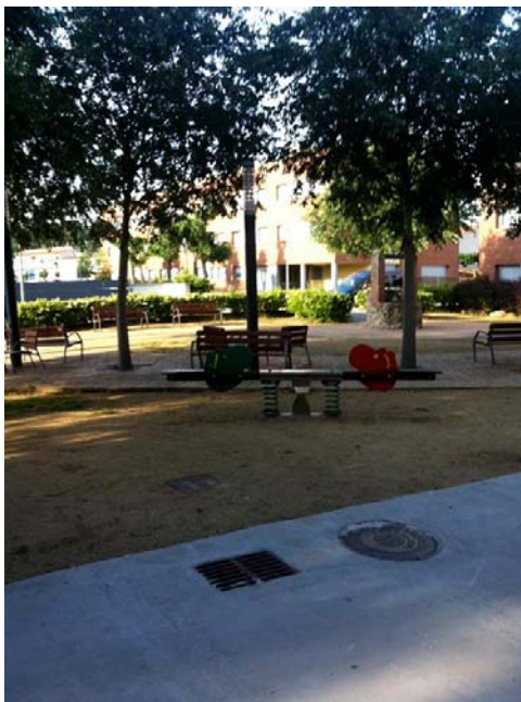
Fotografia 6: Embornal afectat a prop d'un parc infantil. Ptge. Terrisser
