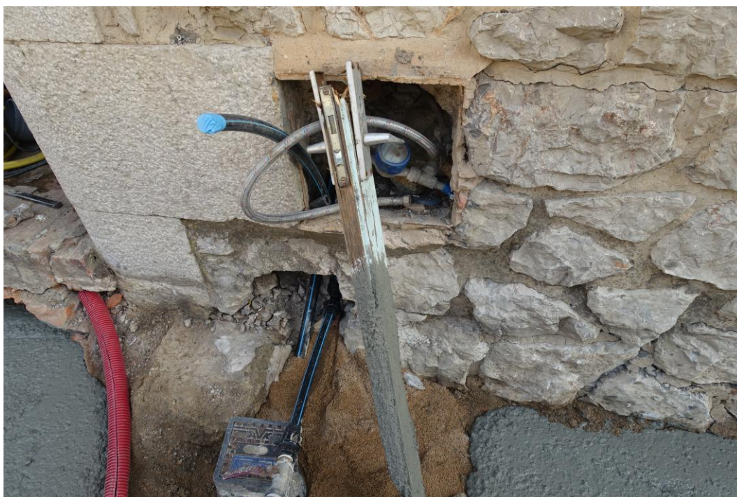
Instal·lació d'aigua potable
