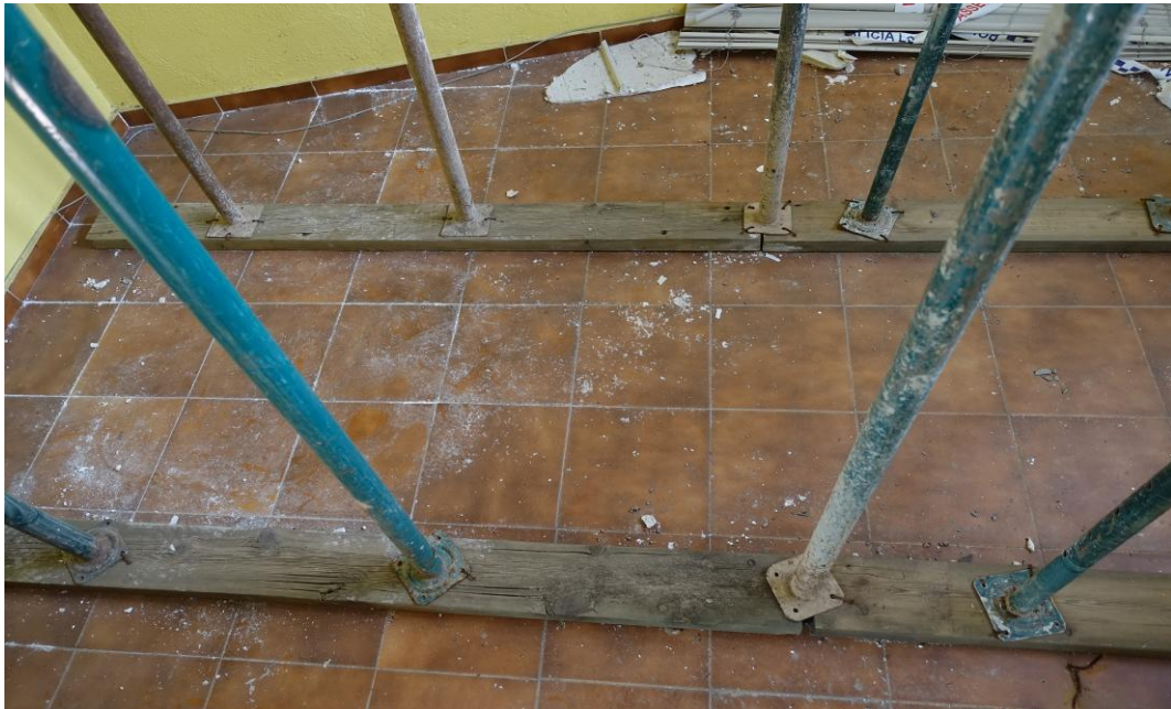
Estat de conservació del paviment
