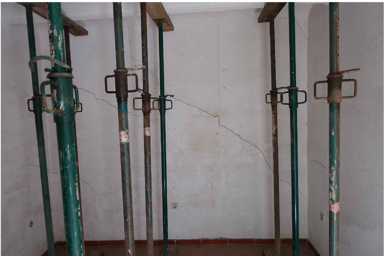
Trencament de la cara interior de la façana principal
