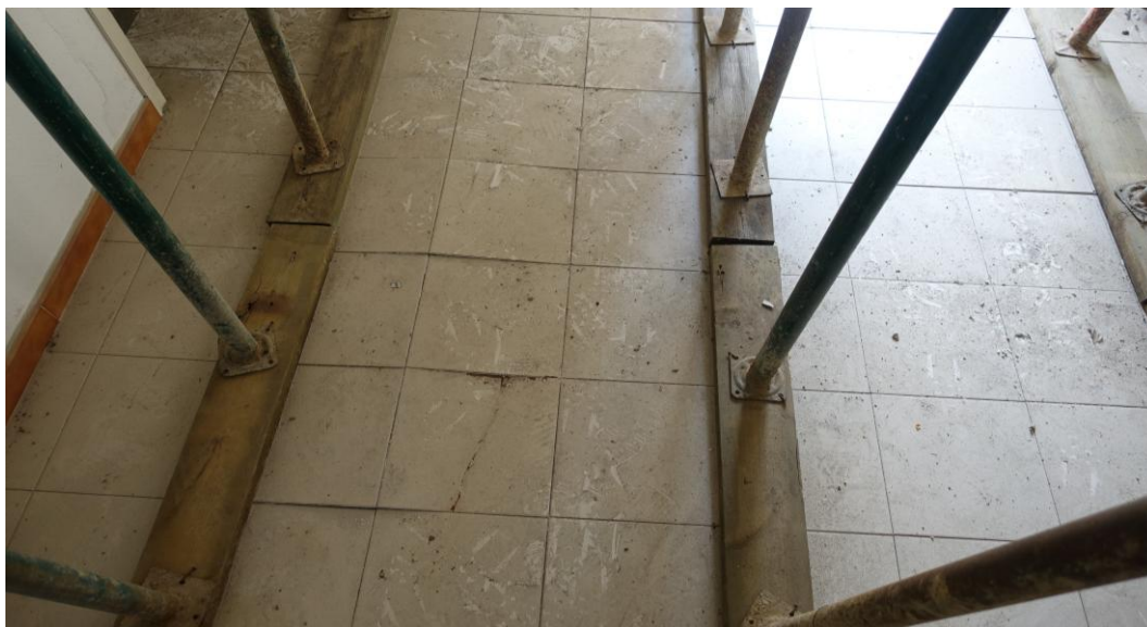
Imatge de l'estat de conservació del paviment
