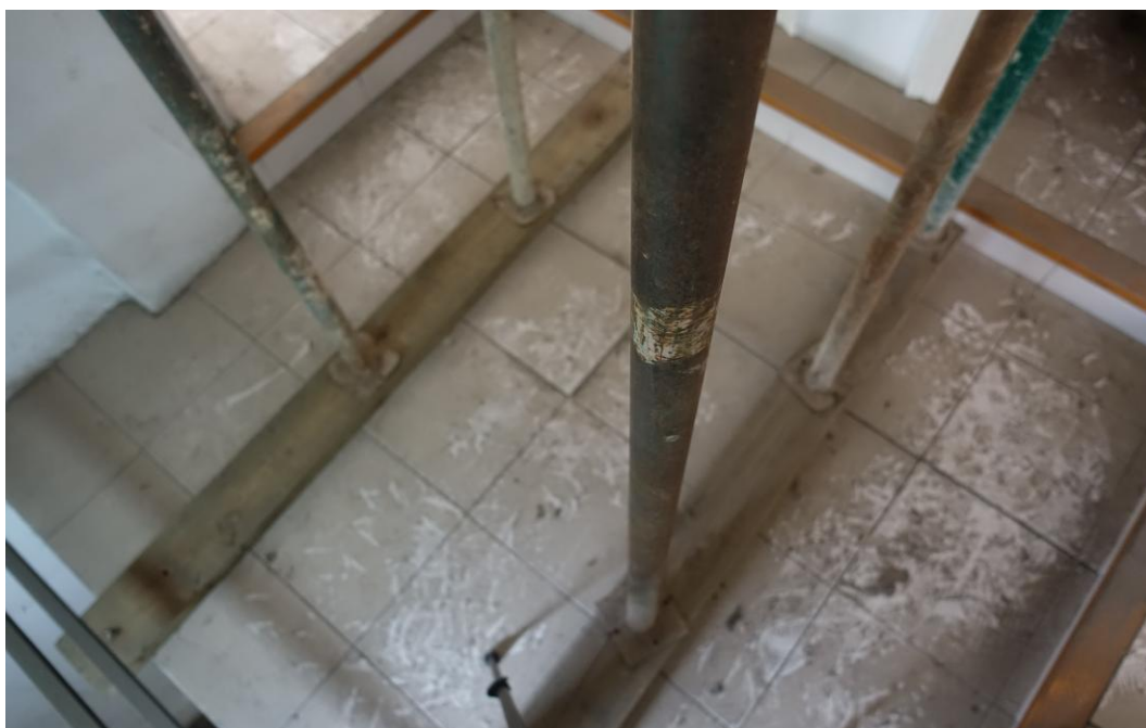
Imatge de l'estat de conservació del paviment
