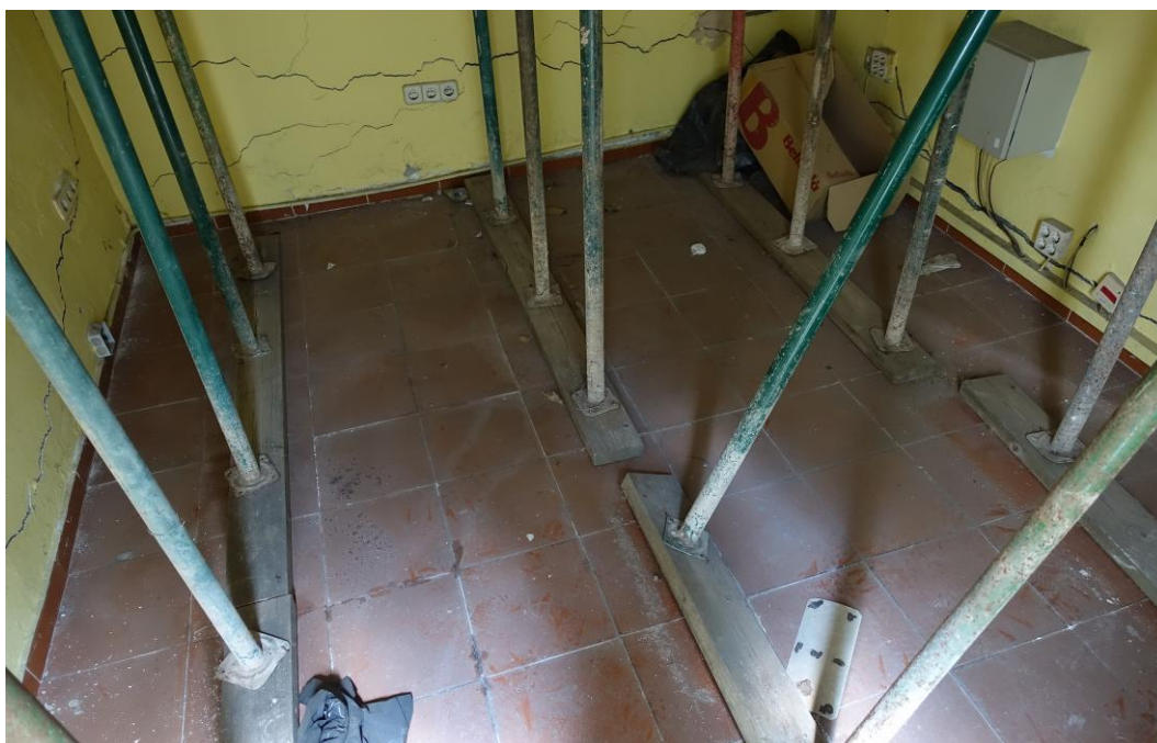
Imatge de l'estat de conservació del paviment
