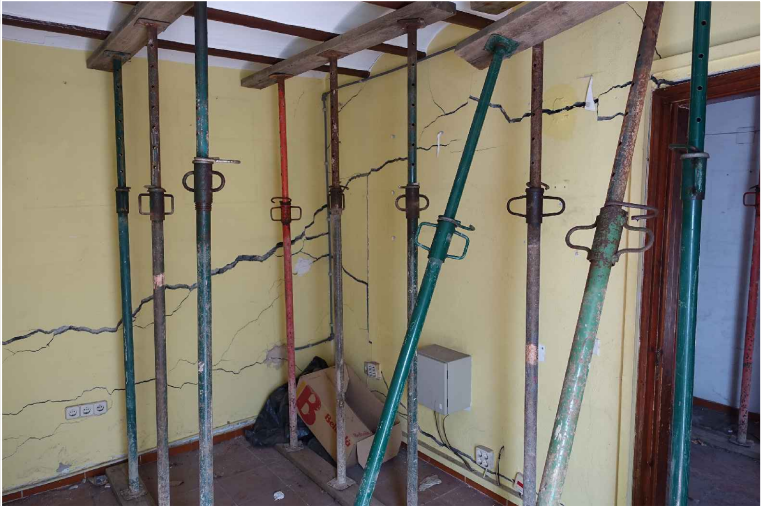
Estat previ del pas d'instal·lacions encastades a l'entrada
