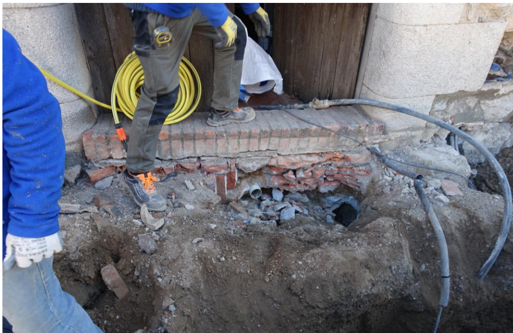
Imatge de les instal·lacions de l'edifici Masó a l'avinguda de Lluís Companys
