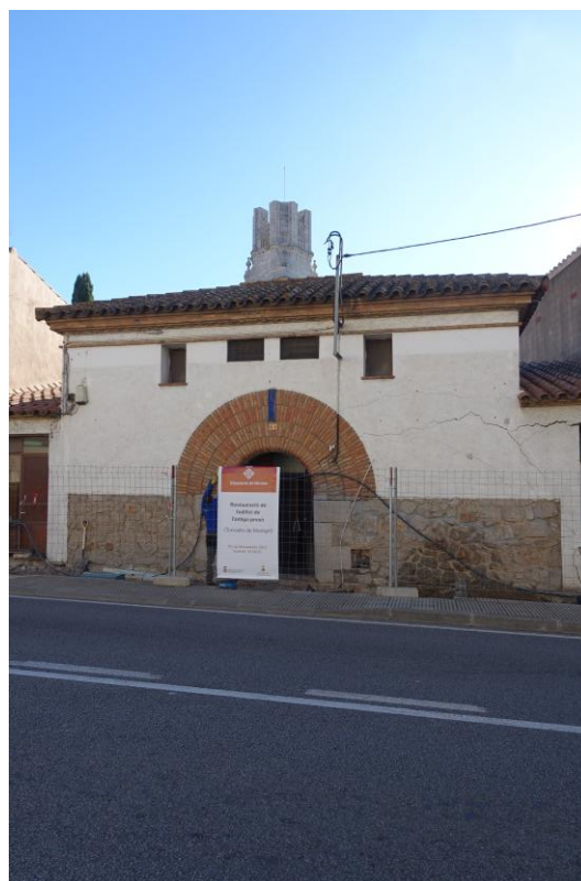
Imatge general de l'edifici en el procés d'actuació d'urgència l'any 2024
