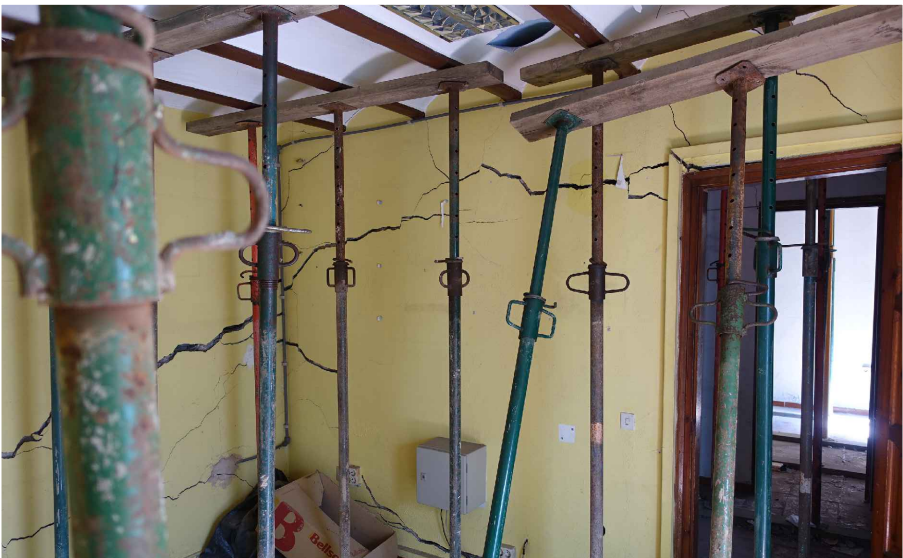
Estat de conservació dels espais interiors de la planta baixa.
