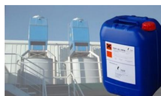
Tratamiento de agua
