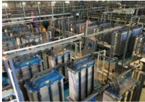
Imatge 1. Instal·lació EDR actual
