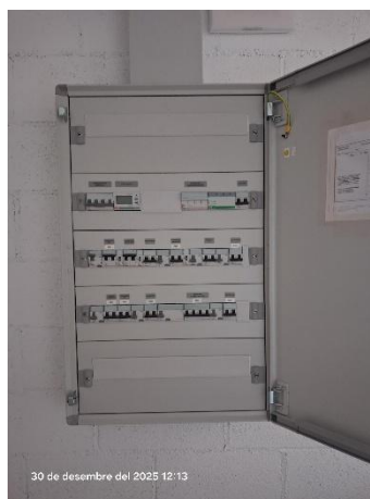
Fotografia 02 – Vista del quadre elèctric
