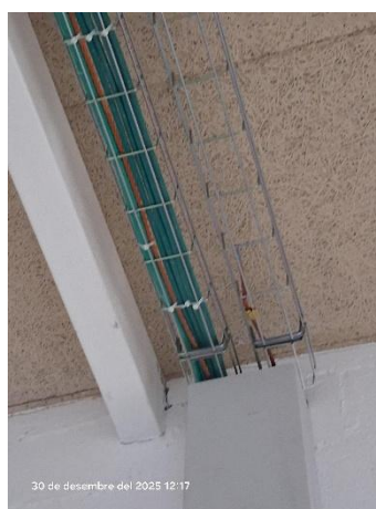
Fotografia 22 – Vista magatzem (safata de cables)
