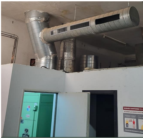
Imatge 3: Sistema de calefacció
