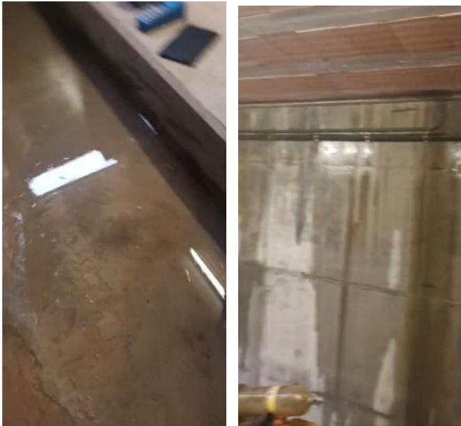
Il·lustració 5: entrada aigua parets laterals
