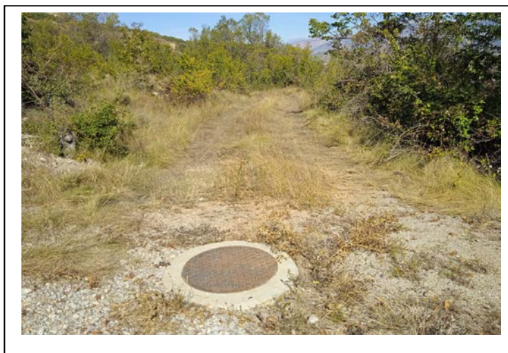
Imatge 23: Arqueta existent on fer l'escomesa
