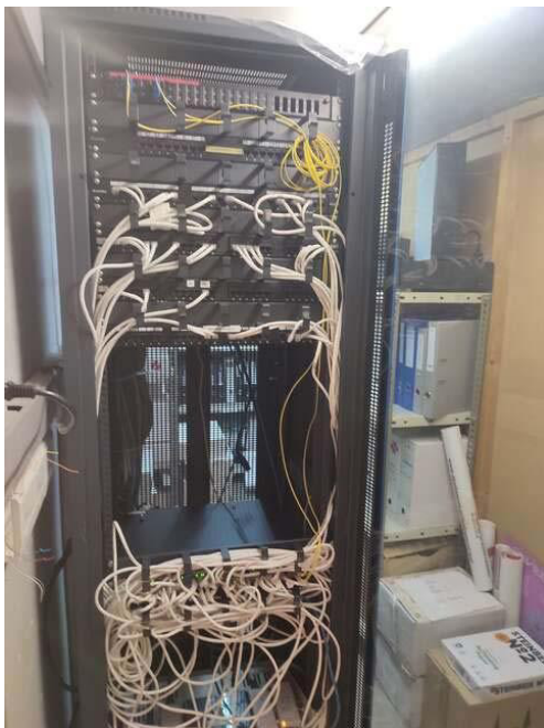
Armari rack del Centre Cívic Sant Narcís des d'on sortirà el nou cable de 16FO cap al Xalet Sant Narcís
