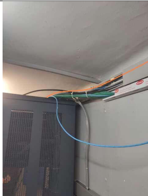
Sortida del cable de 16FO per les canaletes de PVC a la part posterior de l'armari rack del CC Sant Narcís
