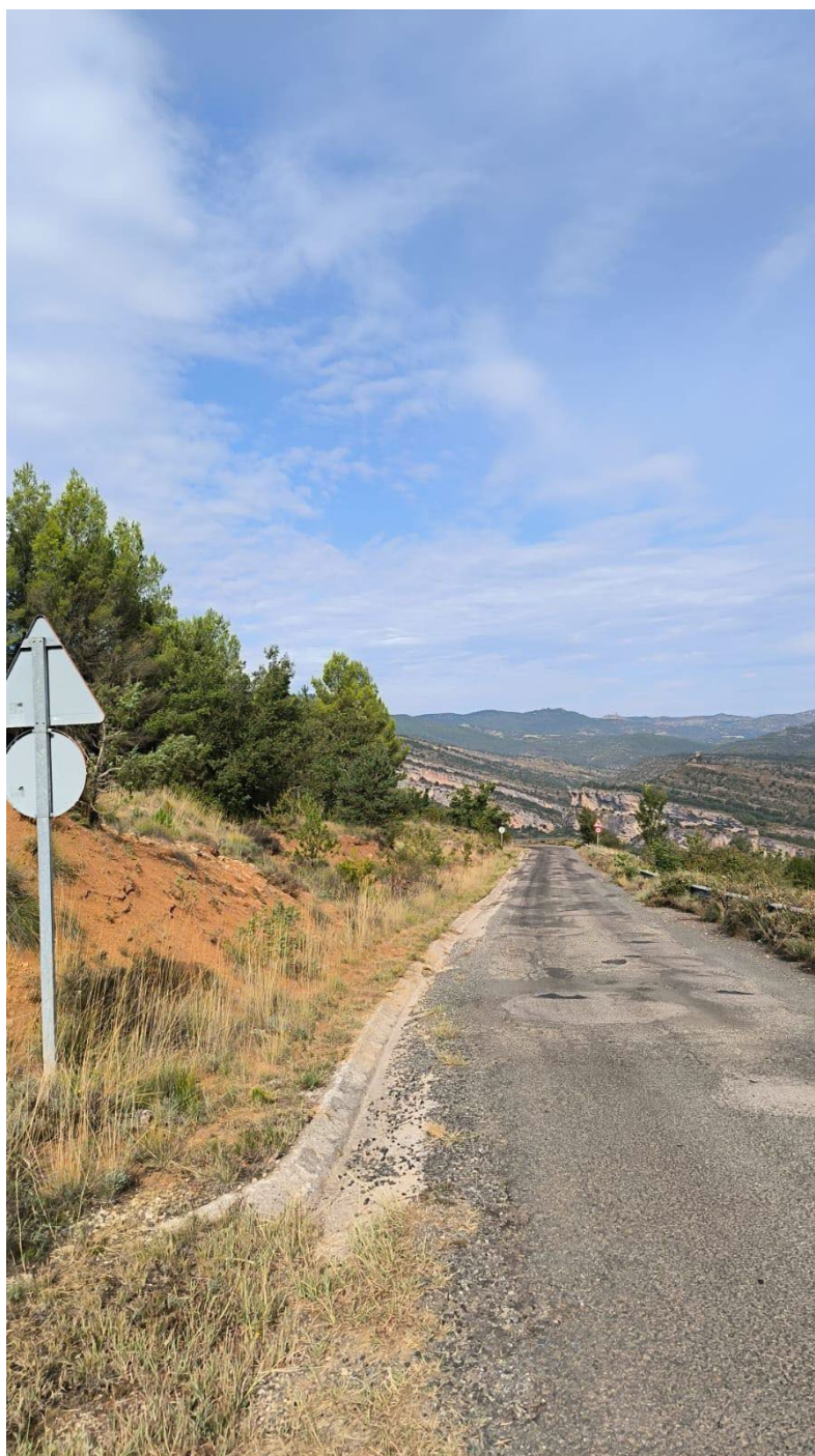
Foto 6 Camí dels Llocs de Feixa. Patologies de la carretera.. PK 0+1.100. Font: pròpia, 2025/08/21
