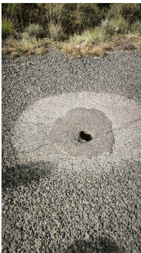
Foto 4 Camí dels Llocs de Feixa. Obra de drenatge transversal i patologies de la via. PK 0+990. Font: pròpia, 2025/08/21
