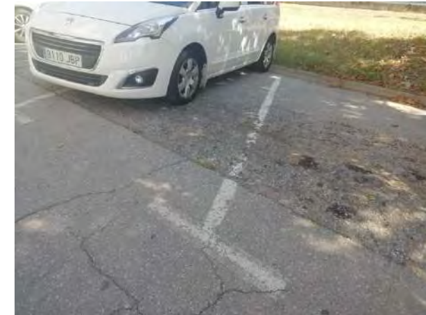
Estat de l'asfalt del passeig de la riera: esquerdes, forats i flonjalls
