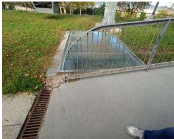
Lluerna a reparar
