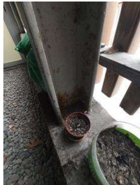
Estructura metàl·lica a reparar
