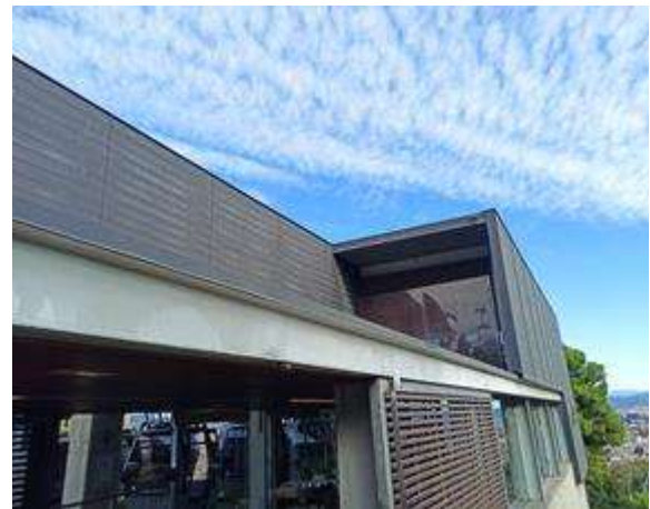
Accés a estació amb filtracions a reparar
