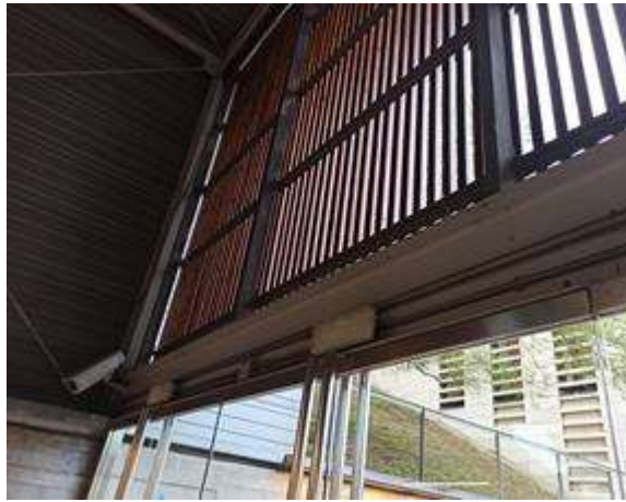
Estructura metàl·lica a reparar
