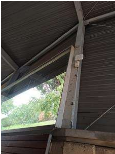
Estructura metàl·lica a reparar
