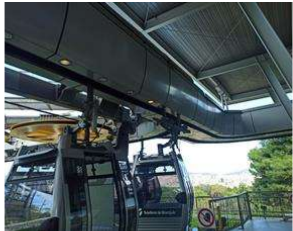
Estructura metàl·lica a reparar
