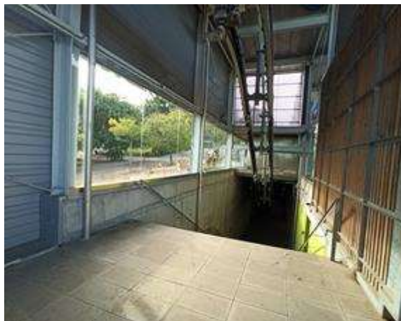
Estructura metàl·lica a reparar
