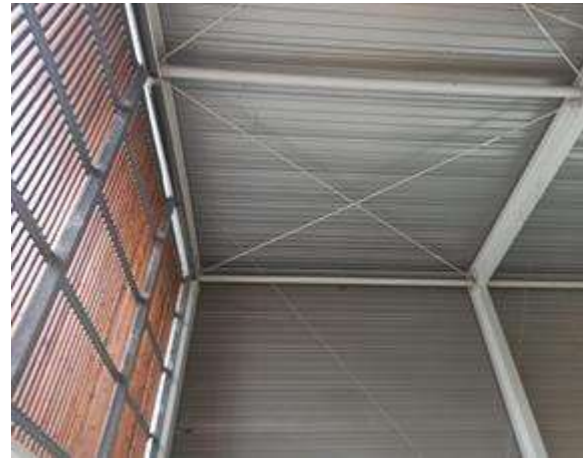
Estructura metàl·lica a reparar
