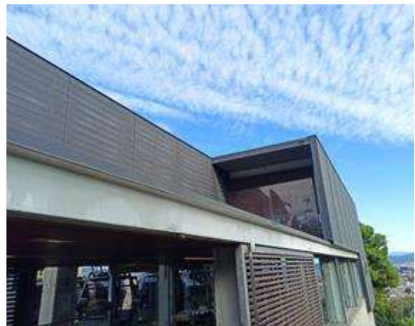
Estructura metàl·lica a reparar
