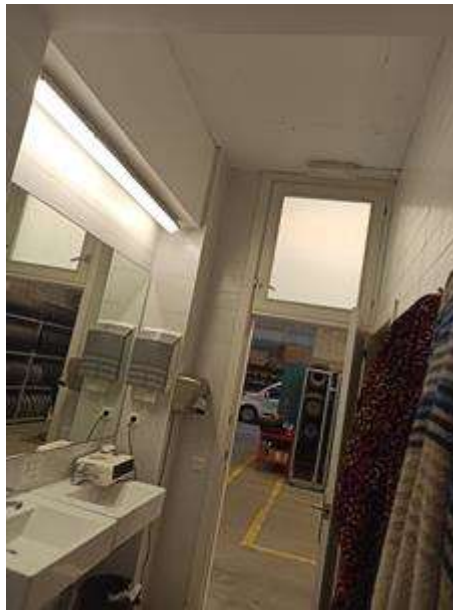
Porta i finestra superior a substituir
