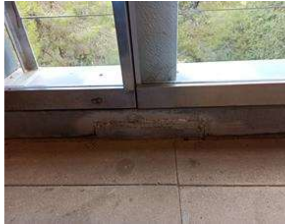
Estructura metàl·lica a reparar
