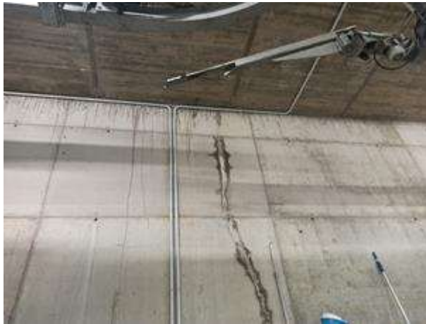
Filtracions al taller
