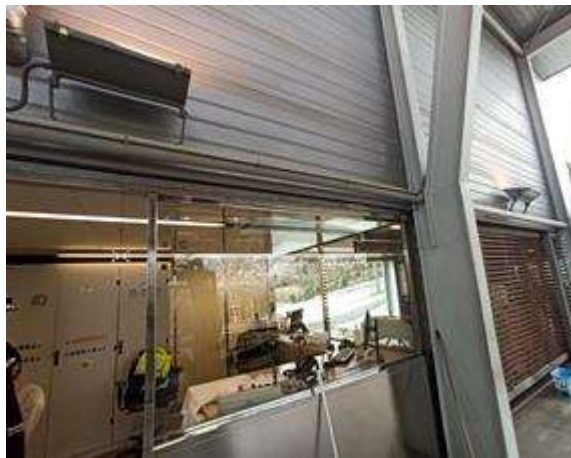
CGE amb filtracions a reparar
