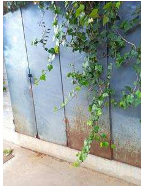
Portes exteriors a substituir
