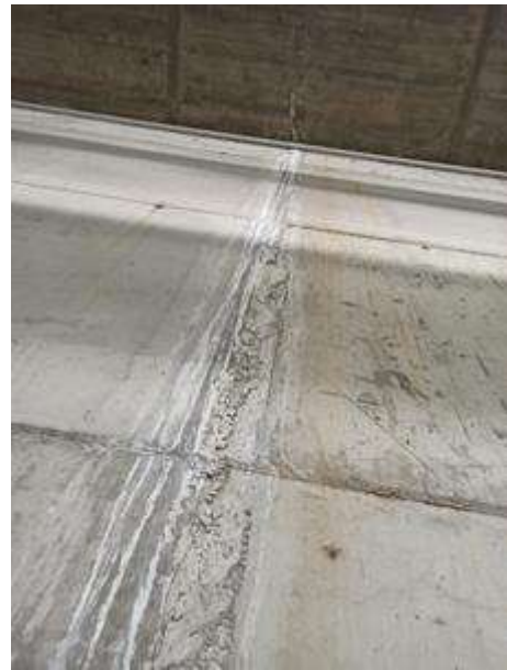
Filtracions al taller
