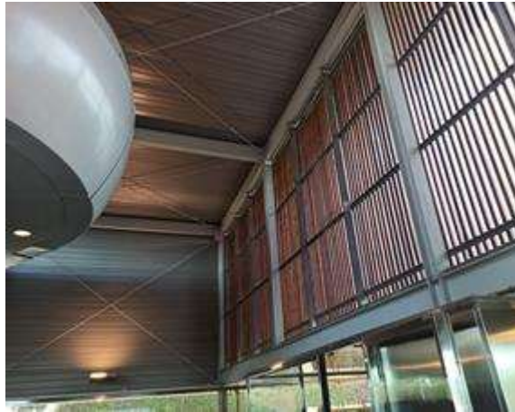
Estructura metàl·lica a reparar
