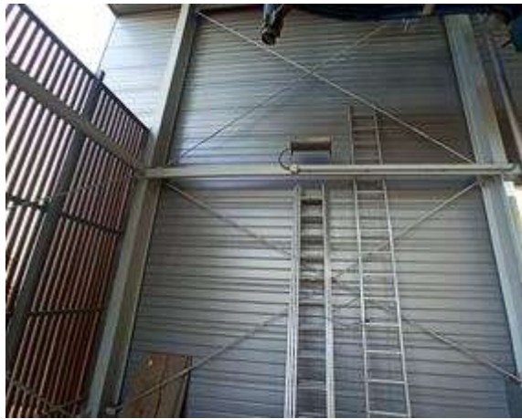
Estructura metàl·lica a reparar
