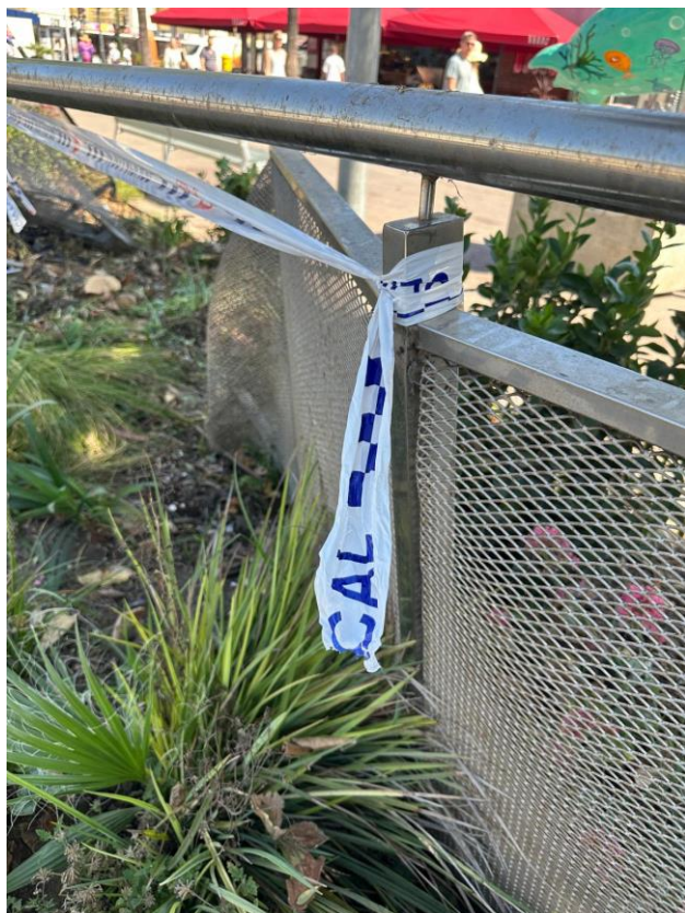
Figura 3- Afectació de la barana per l'accident de trànsit. Estat en que va quedar la barana.
