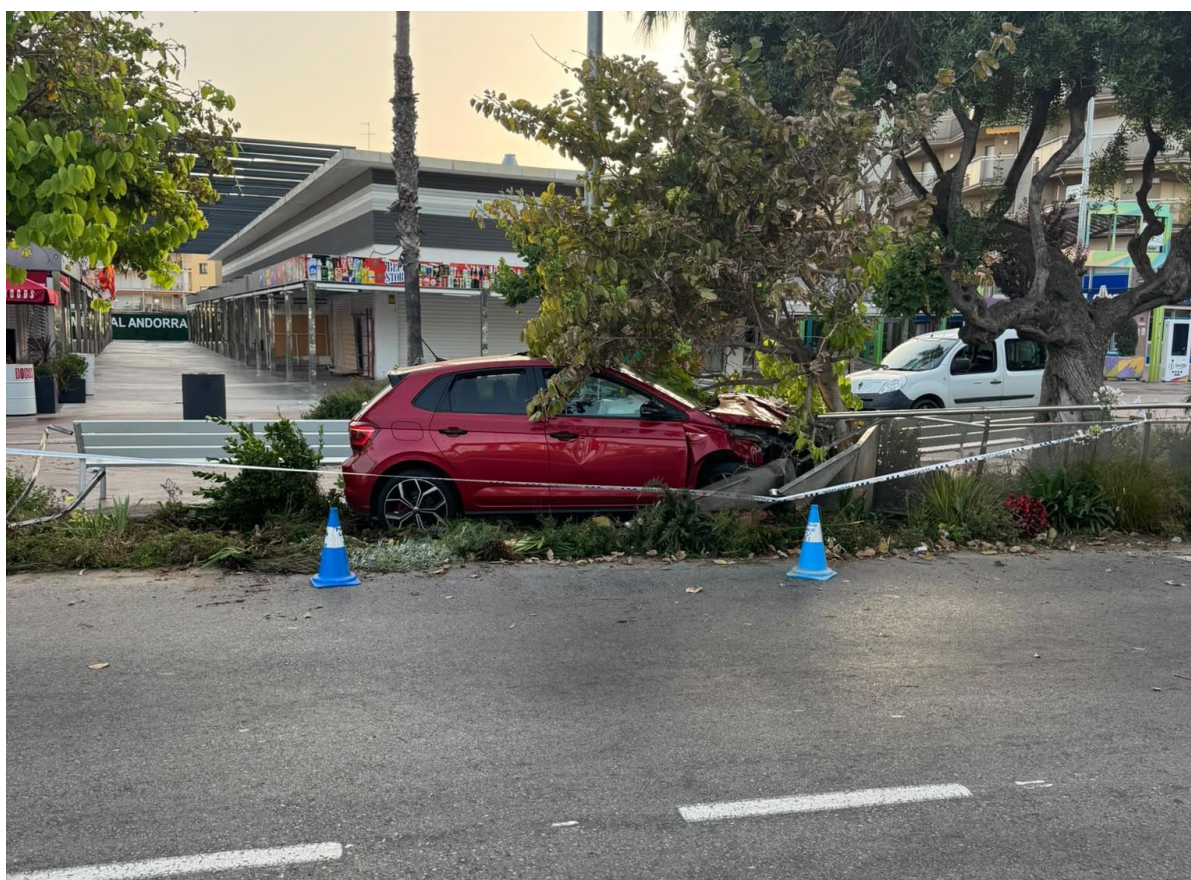
Figura 7- Afectació de la barana per l'accident de trànsit
