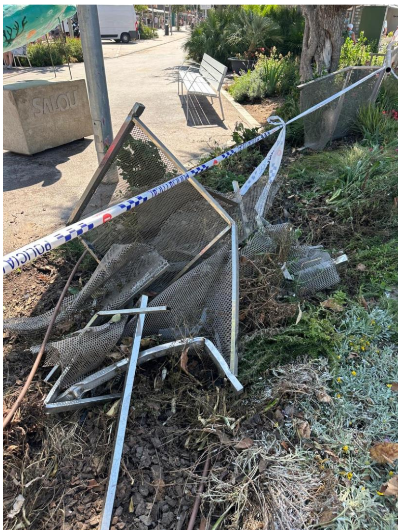
Figura 2- Afectació de la barana per l'accident de trànsit. Estat en que va quedar la barana.
