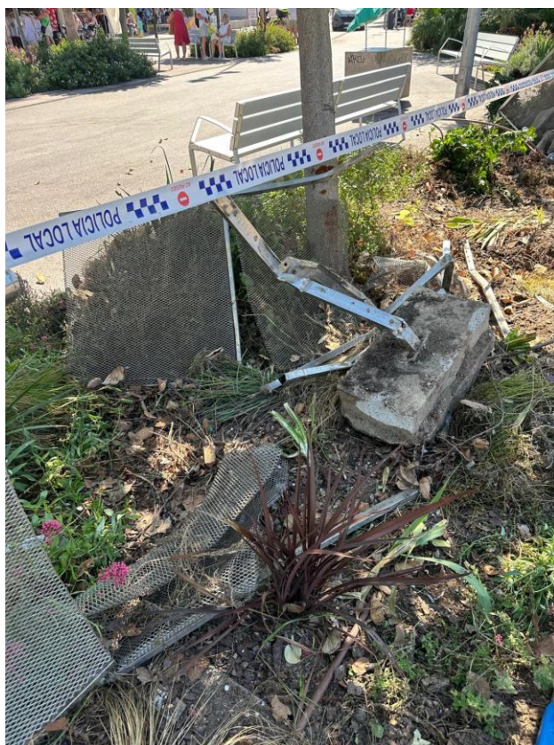
Figura 4- Afectació de la barana per l'accident de trànsit. Afectació en els fonaments.
