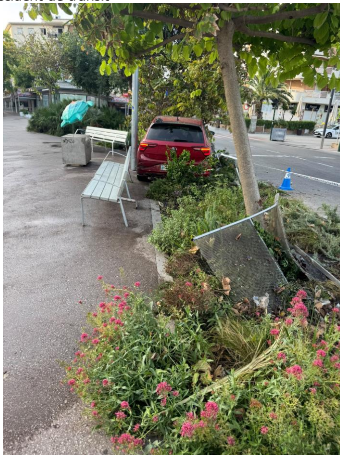
Figura 6- Afectació de la barana per l'accident de trànsit
