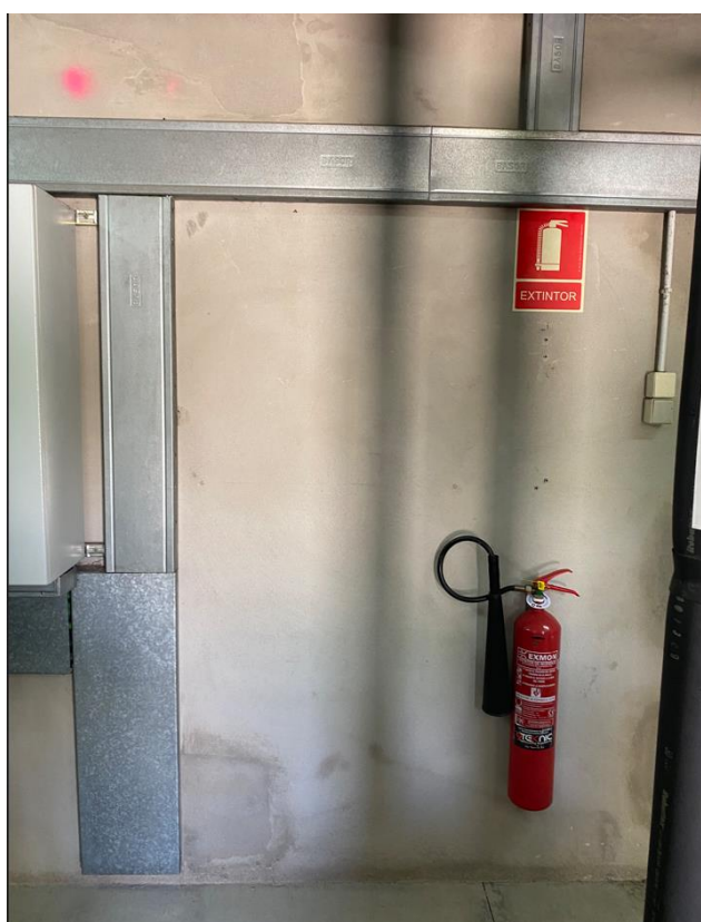
Fotografia 4. Paret on s'ubica l'inversor
