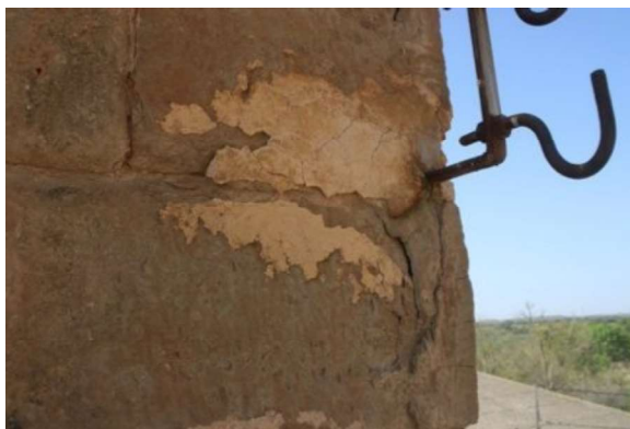
Fragmentació d'un carreu associada a les oscil·lacions tèrmiques en presència de ciment i d'un ancoratge metàl·lic. Es preveu el tractament mitjançant impregnació amb consolidant i posterior adhesió amb morter hidràulic.
