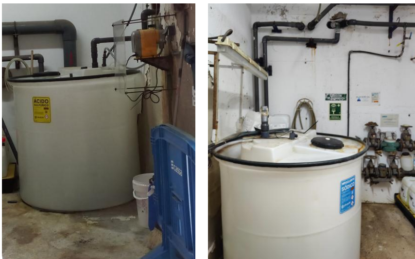
Dipòsits d'àcid sulfúric i hipoclorit sòdic
