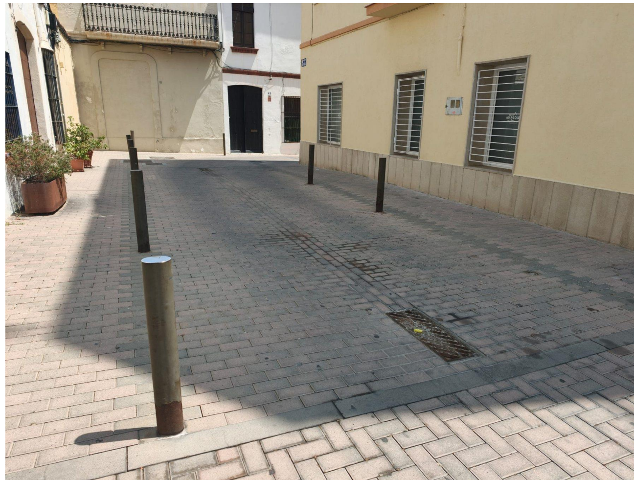
Fotografia 8. Zona central amb pilones i paviment amb reparacions puntuals pendents.
