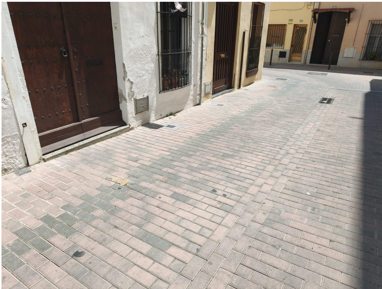
Fotografia 7. Detall de forats i marques al paviment corresponents a elements de mobiliari retirats anteriorment.
