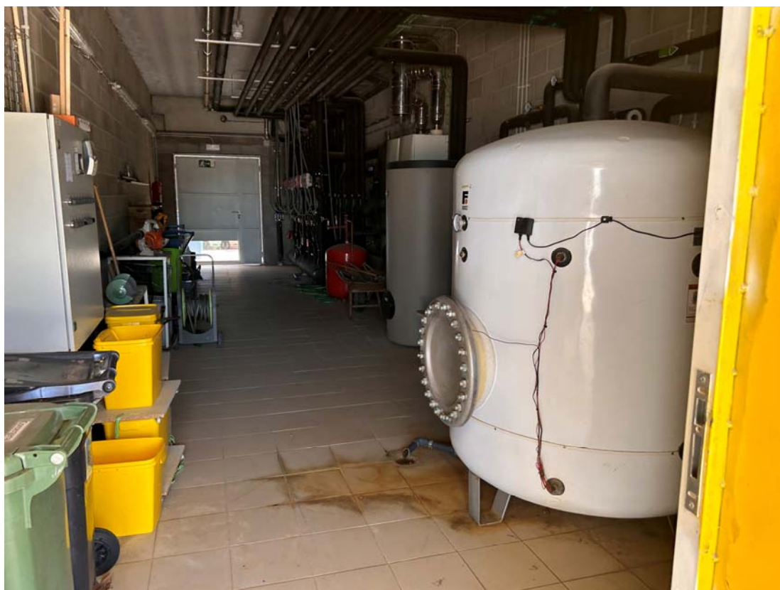
Vista general sala de calderes
