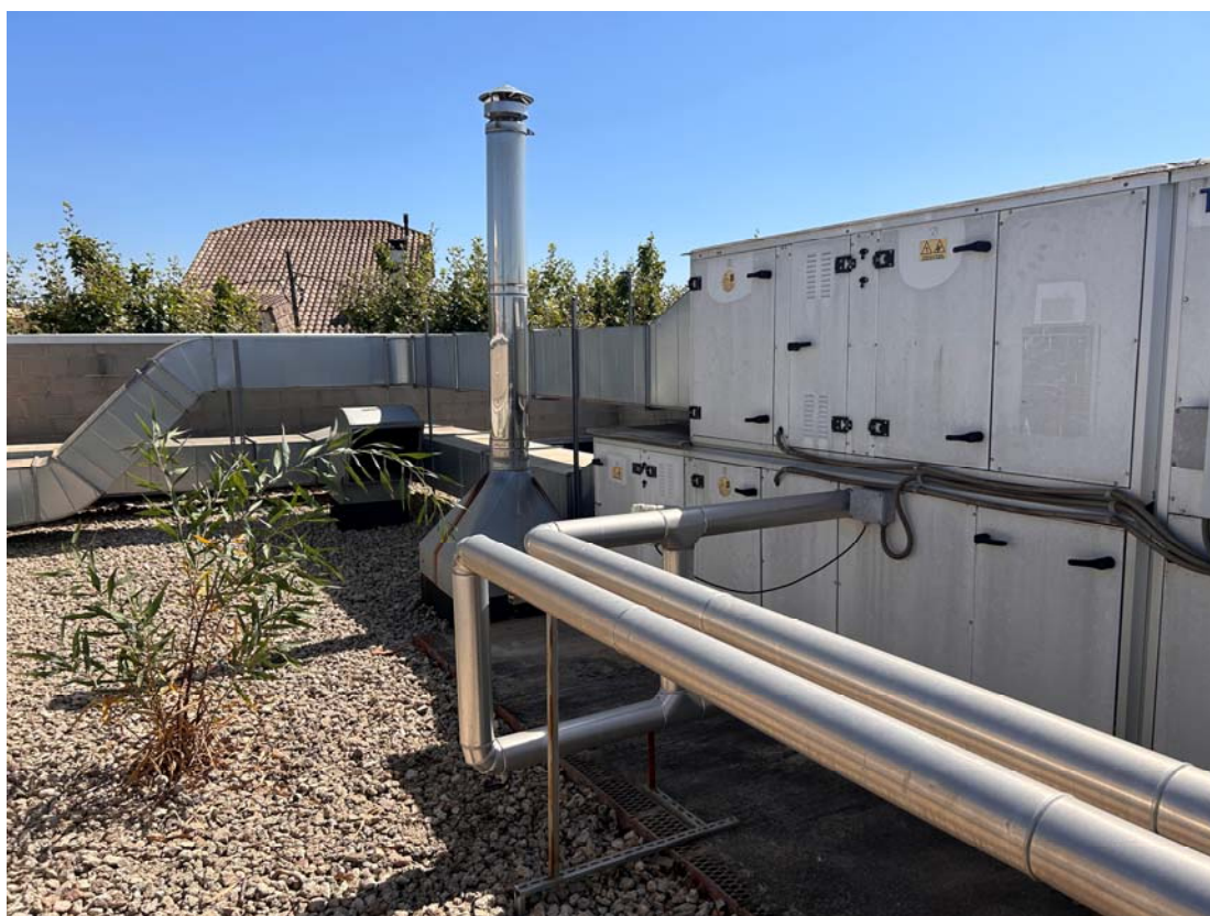
Vista tuberíes d'aigua i situació de la nova bomba de calor
