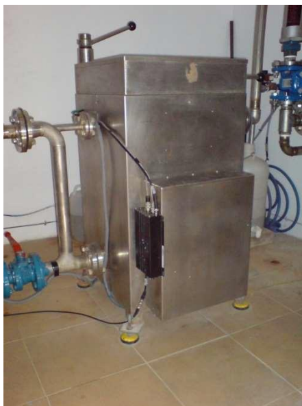
Detalle del módulo blindado de la red RVE
