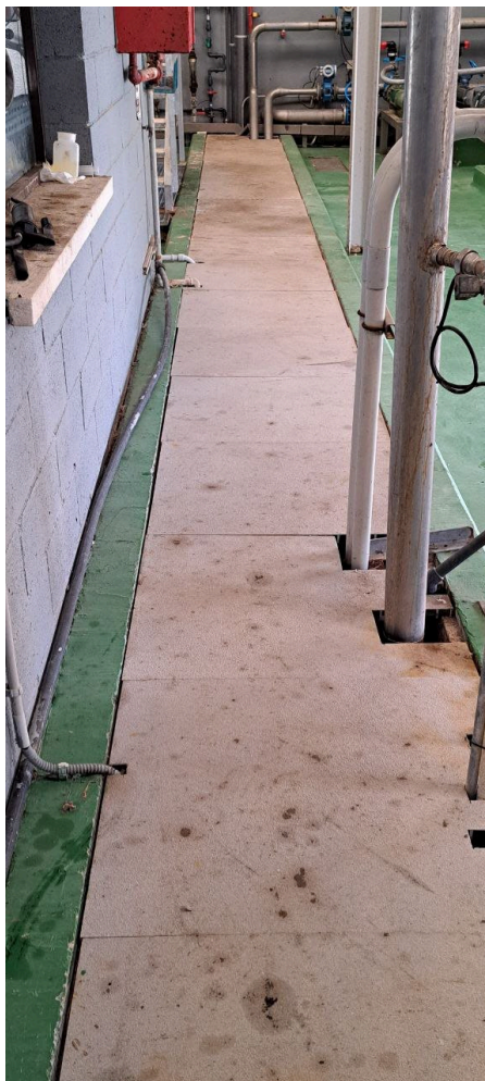
Canalitzacions de cable per on passar la nova escomesa a l'interior de la nau CCM1
