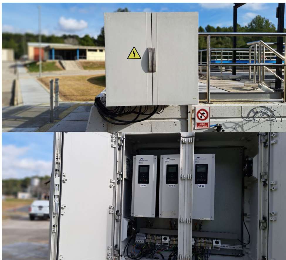
Quadre elèctric de les bombes de fangs en excés amb els variadors a instal·lar dins del nou CCM3
