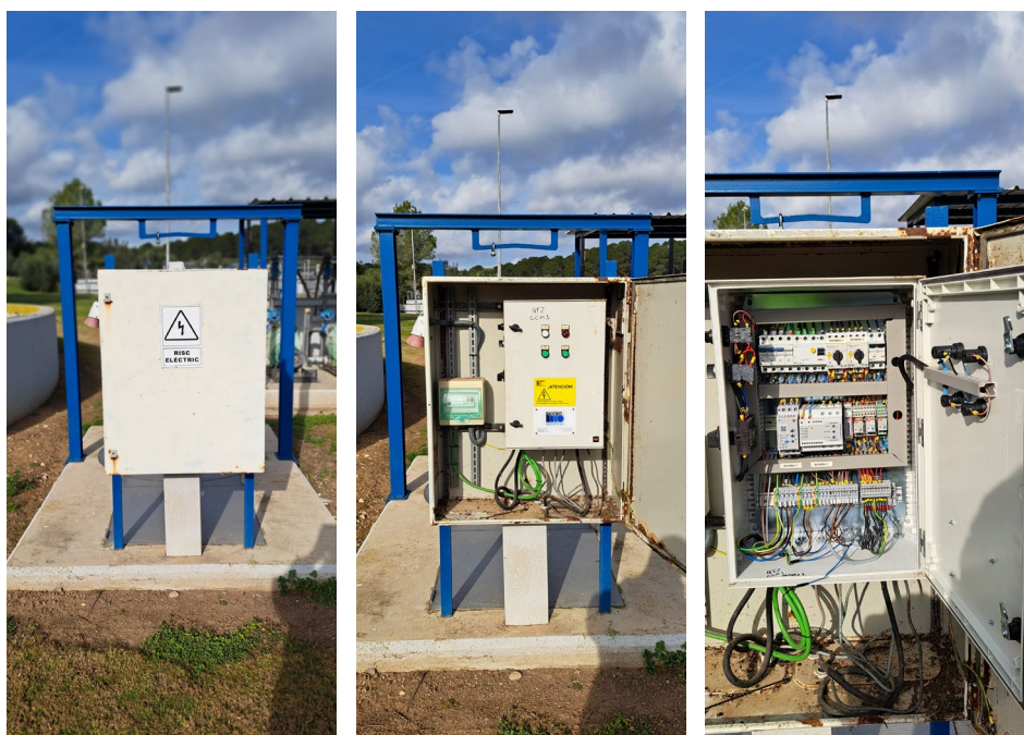
Quadre elèctric de les bombes de fangs flotants. Aquest quadre desapareix i les bombes estaran controlades des de el nou quadre elèctric
