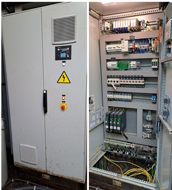
Estat actual del quadre elèctric
