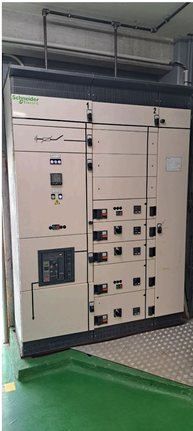
Armari de distribució (QGBT) on s'instal·larà el nou cubicle d'alimentació del CCM3
