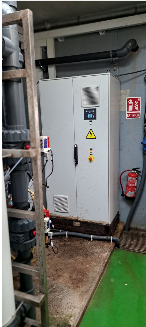
Ubicació de l'actual quadre elèctric on s'instal·larà el quadre d'interconnexió
