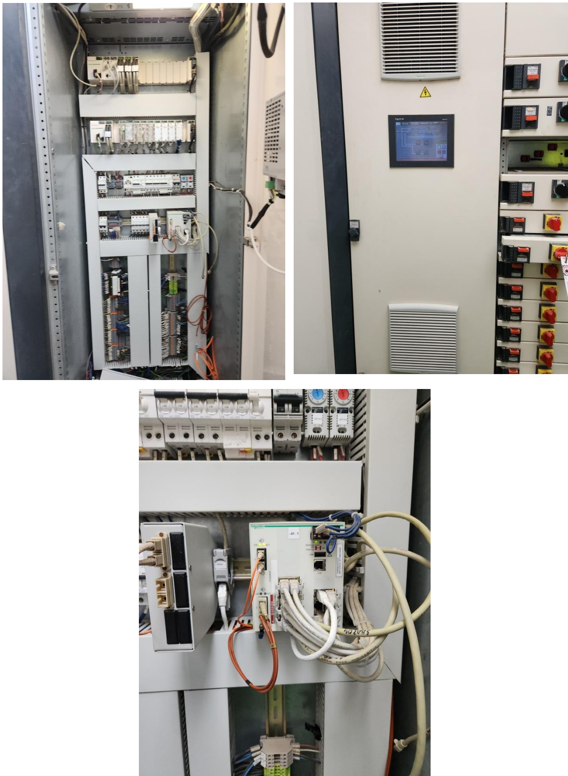
Elements existents de control, comunicació o supervisió relacionats amb la integració dels nous senyals al sistema SCADA de l'EDAR.
