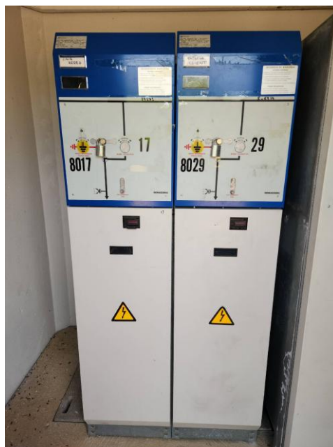
Fotografia 4. Detall de la cel·la d'escomesa o entrada de mitja tensió
