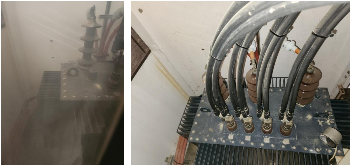
Detall de les connexions de mitja tensió del transformador existent i del pont de mitja tensió.
