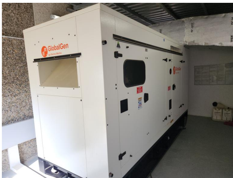
Fotografia 14. Grup electrogen existent
