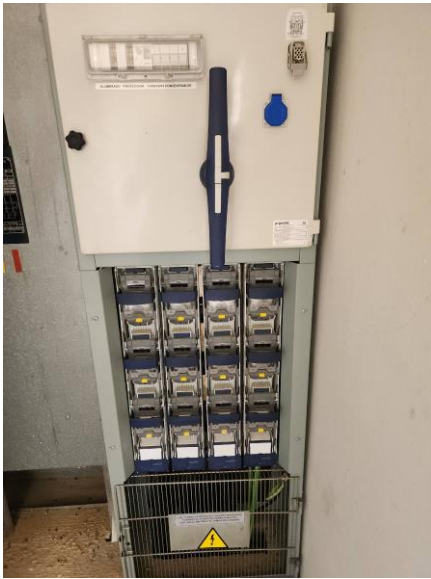
Fotografia 11. Armari o quadre de baixa tensió existent
