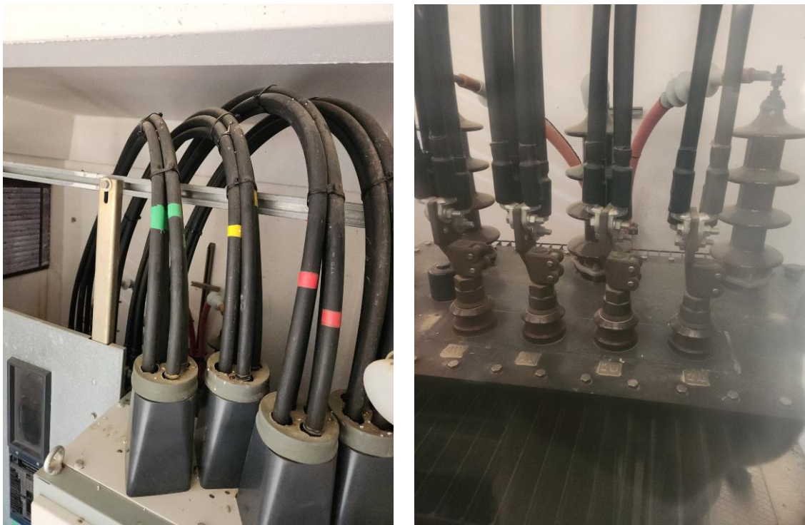
Detall de les connexions de baixa tensió del transformador existent i del pont cap al quadre o armari de baixa tensió.
