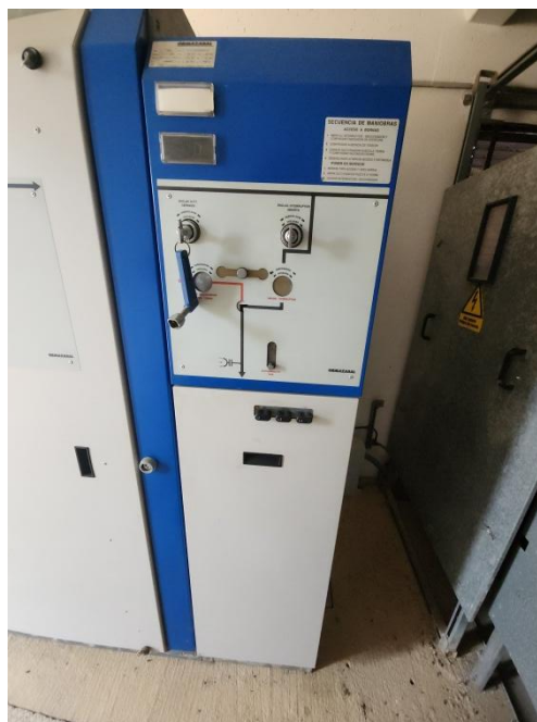
Fotografia 6. Detall de la cel·la de protecció del transformador
