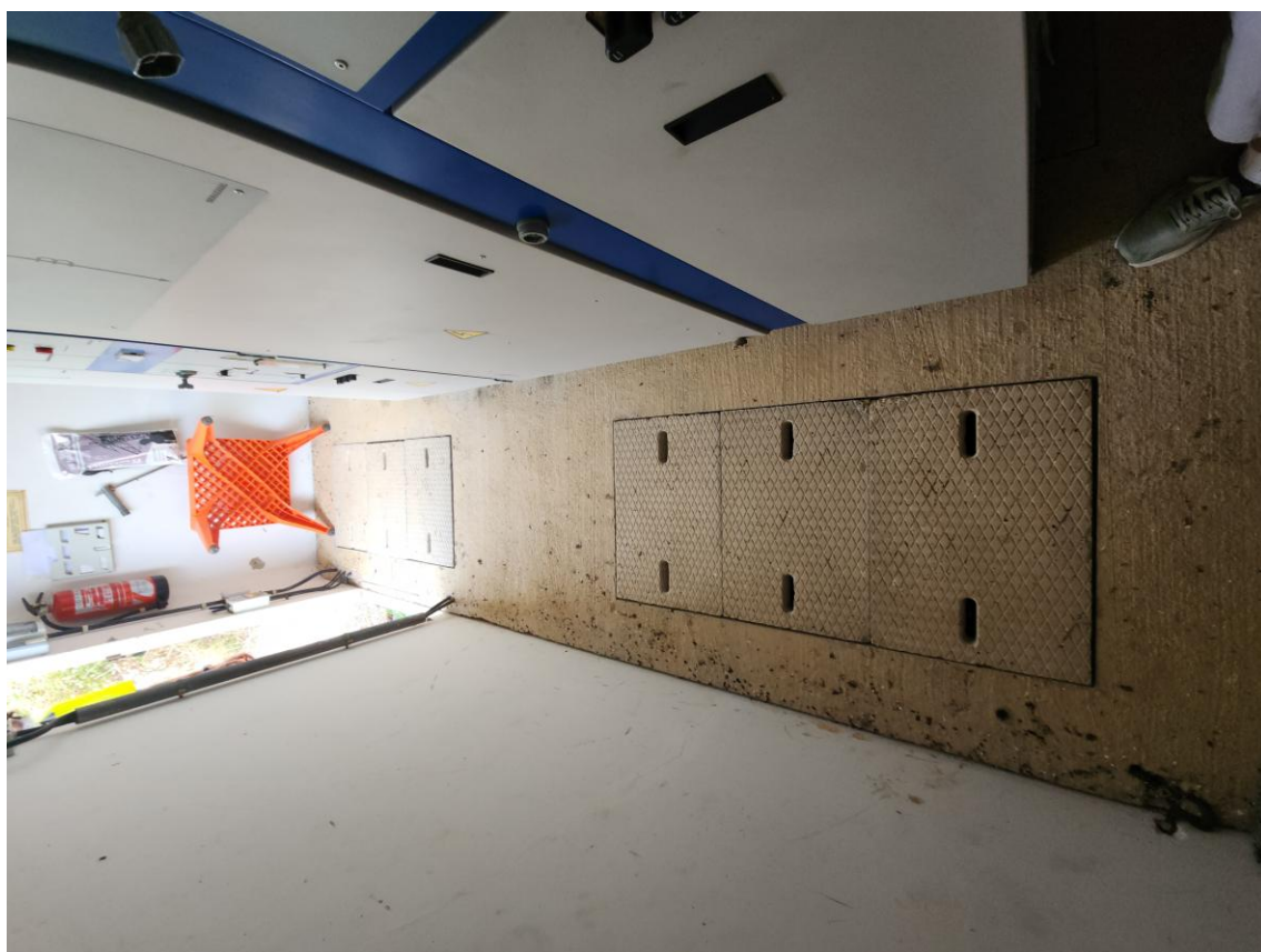
Fotografia 13. Rases, passos de cables i bancades
