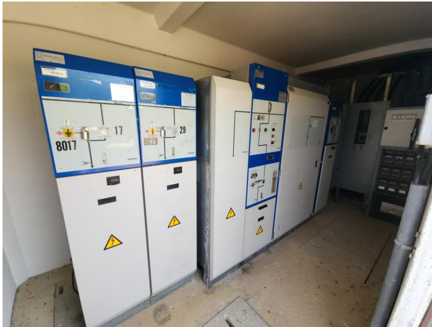
Fotografia 3. Vista general de les cel·les de mitja tensió existents
