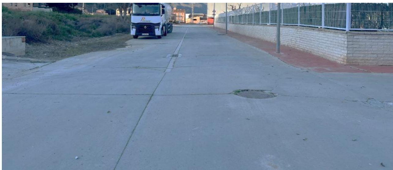
Imatge 1. Zona a reparar per enfonsament parcial.
