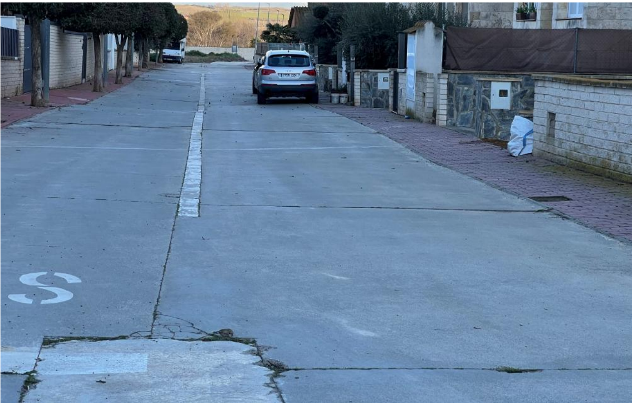
Imatge 3. Fissures i irregularitats existents en calçada i vorera.
