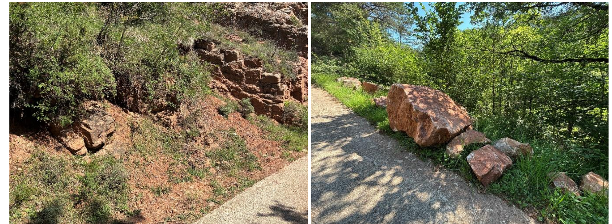
Figura 1. Estat actual del talús objecte d'actuació (esq.) i efectes de les esllavissades a l'altra banda del camí (dreta)
