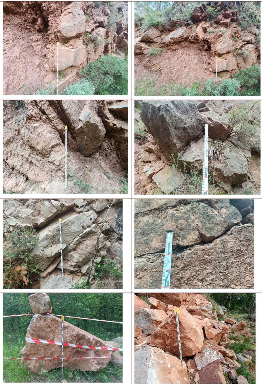
Fig. 4. Mesura de juntes de discontinuïtats i dimensions dels blocs caiguts. Estacions geomecàniques E1, E2, E3 i E4
