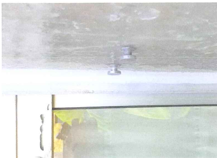
Superficie arrancada de resina
