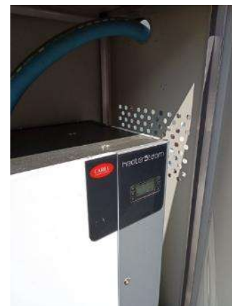
Edifici Annex 2 - Equips sala tècnica
