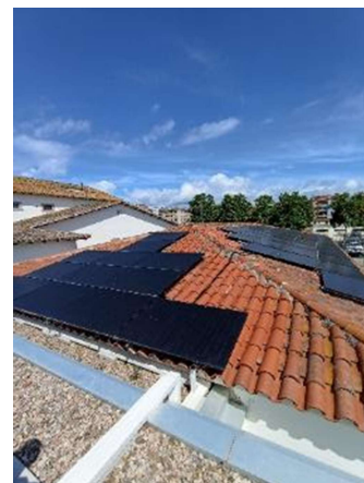
Edifici Annex 1 - plaques fotovoltaïques
