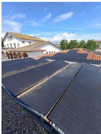
Edifici Annex 2 - plaques fotovoltaïques
