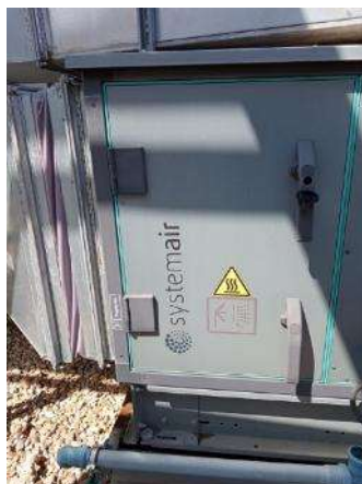
Edifici Annex 2 - Equips sala tècnica
