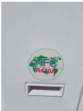
Edifici Annex 2 - Equips sala tècnica
