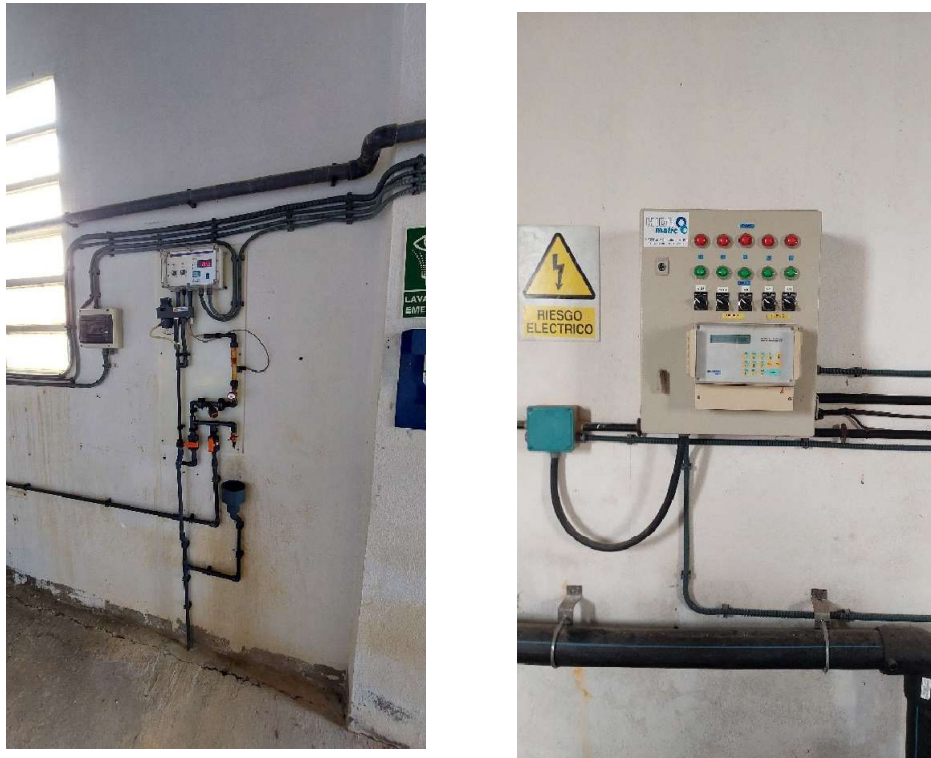
Fotografia 9. Quadre elèctric i aparells de mesures de qualitat de l'aigua.
