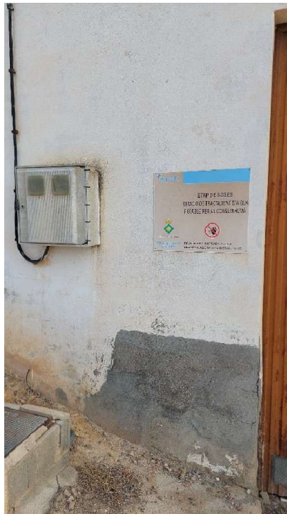
Fotografia 8. Escomesa Aèria, i Caixa de Protecció i Mesura (CPM).
