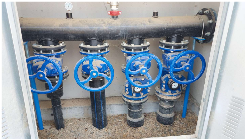
Fotografia 6. Col·lector d'entrada a l'ETAP.
