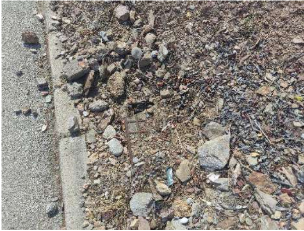
Figura 6 Arqueta tapada pel material arrossegat
