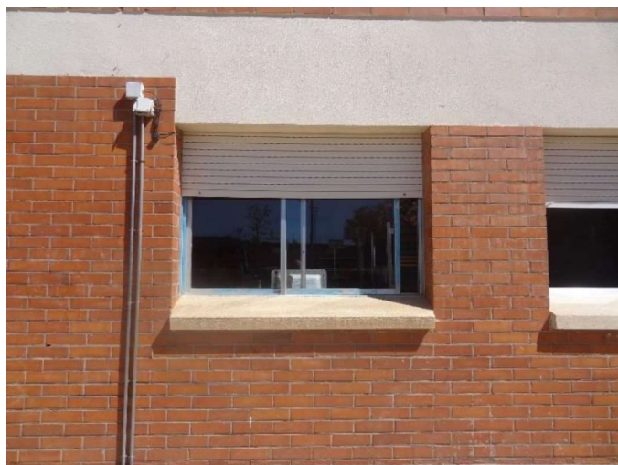
Edifici Infantil. Finestra
