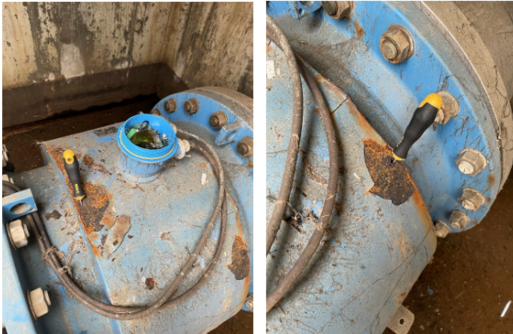
Figures 1 i 2: Vista de l'estat del cabalímetre d'entrada existent a l'ERA de Torroella de Montgrí.
