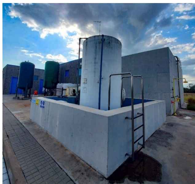
Imatge 1: Vista del sistema existent de desinfecció per cloració de l'ERA de L'Escala.
