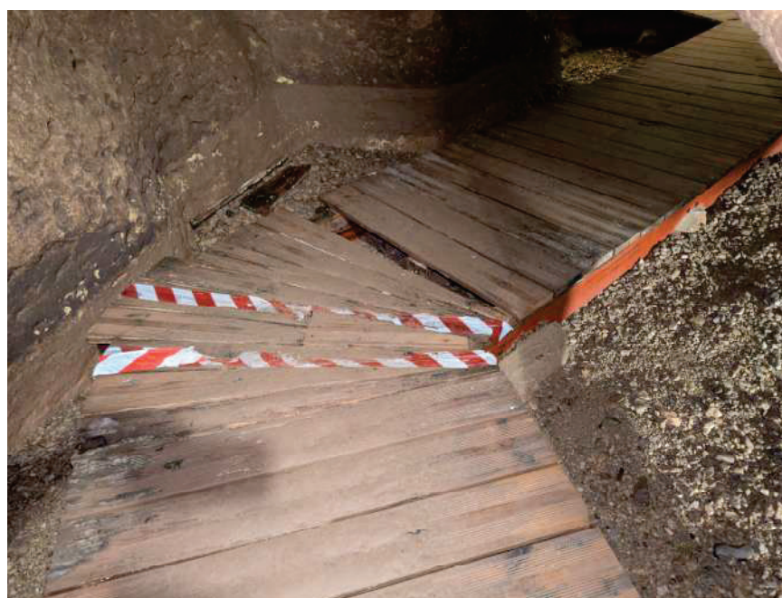
Imatge 12: Estat actual tram pasarel·la a l'interior de la cova
