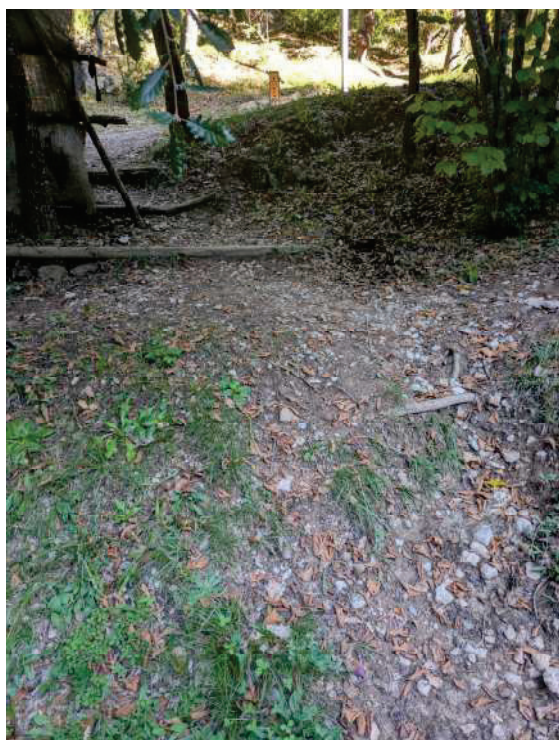
Imatge 10: Estat actual de les escales de fusta a reparar
