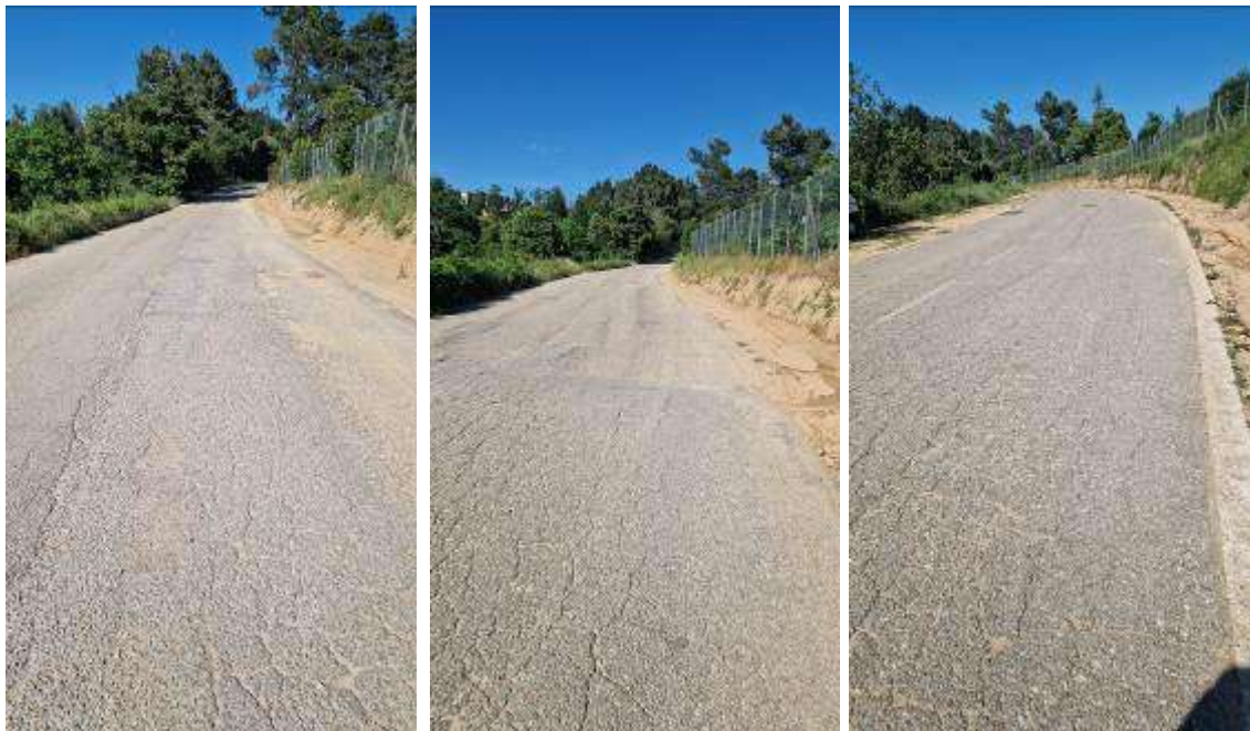
Imatges diverses del tram de carrer a reparar de manera prioritària i preferent.
